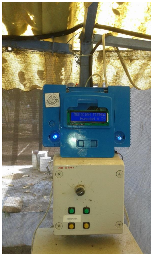
Figura 3.43 Estación meteorológica mostrando la humedad en el suelo
