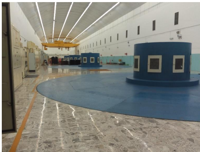
Fig.25 Piso de excitatriz unidad numero I C.H. Malpaso casa de máquinas.
