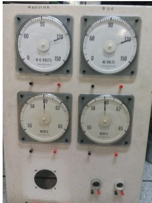
Fig.64 Tablero de sincronización
