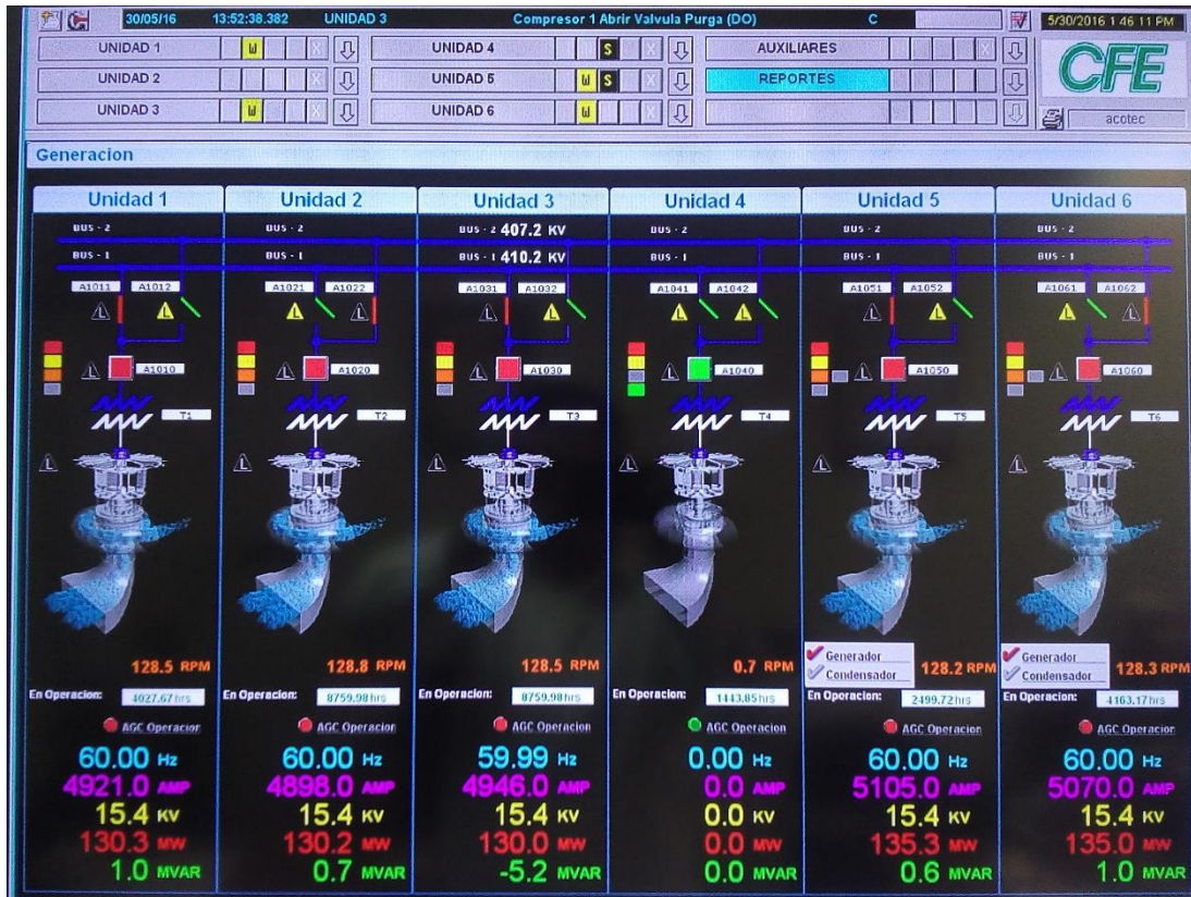
Fig.29 Monitor de estado de los generadores.
