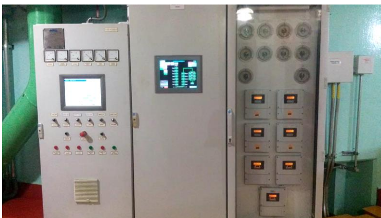
Fig.26 Regulador automático de velocidad unidad V marca Andritz Hydro.
