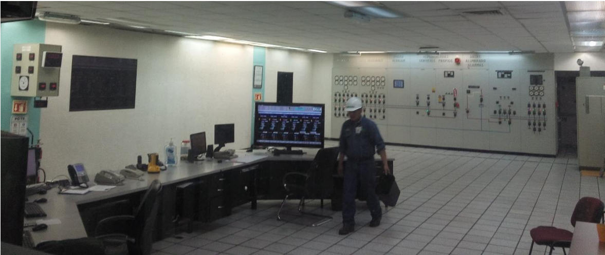
Fig.1 Tableros CH Malpaso.
