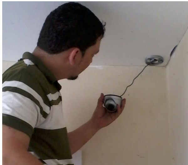
Fig. 27 Instalación de cámaras de domo
