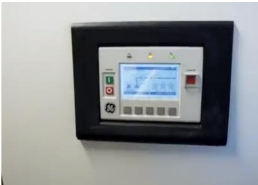
Figura 3.25 - Panel de control en modo de fallo de red.
