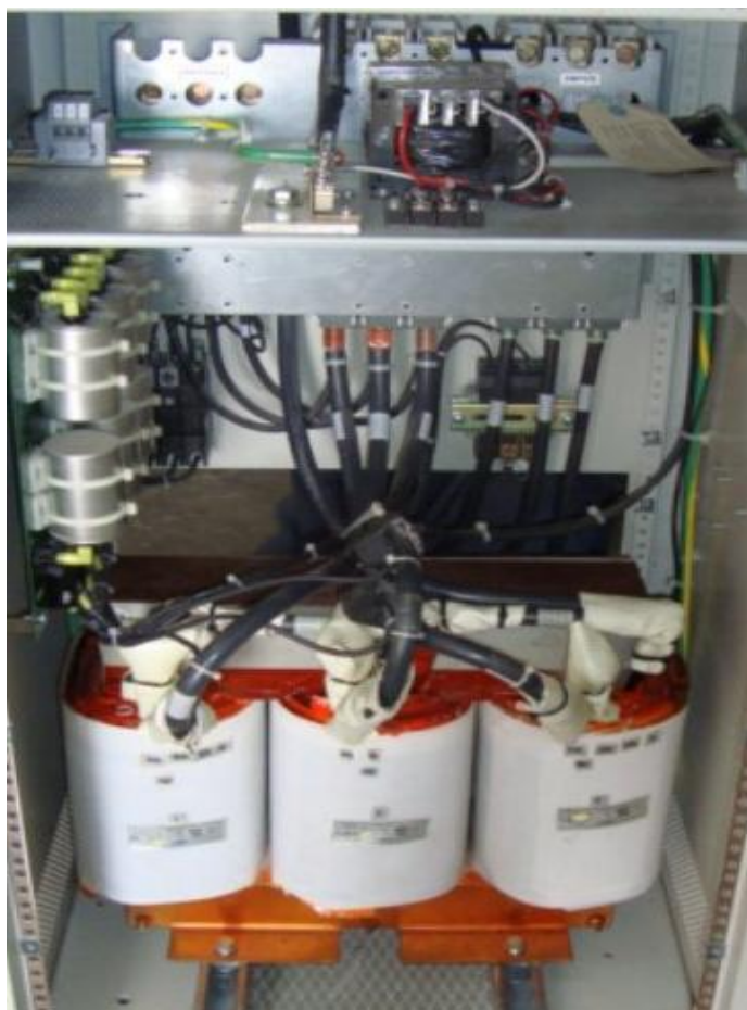
Figura 3.5 - Conexiones internas del UPS modelo LP-33U-30.
