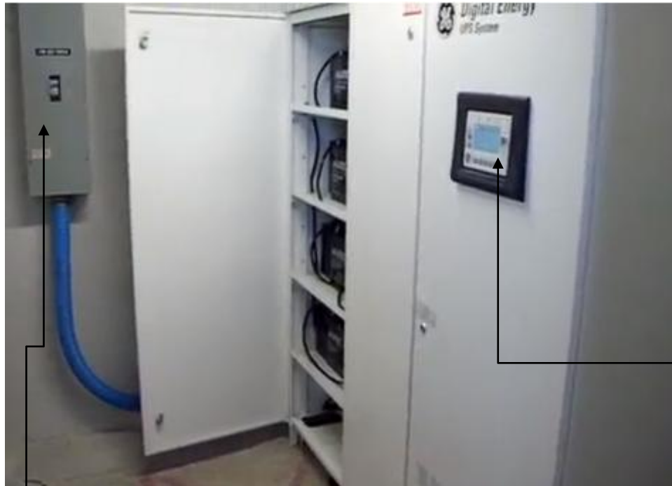
Figura 3.21 - UPS modelo LP-33U-80 energizado
