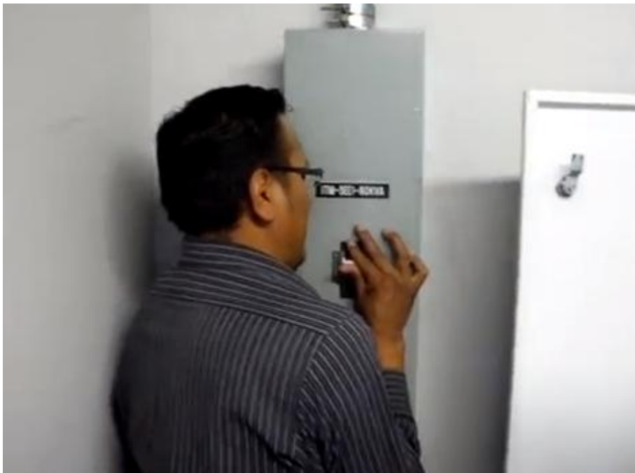
Figura 3.28 - Activación del interruptor de alimentación del UPS.
