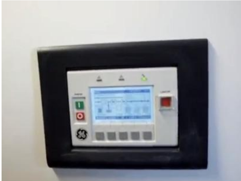
Figura 3.5 – Panel de control en modo de recuperación de la red.
