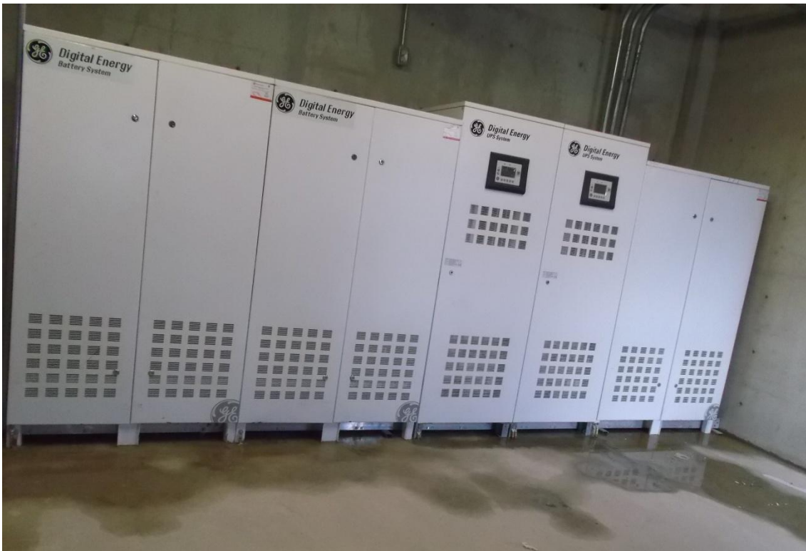
Figura 3.3 – Colocación de los modelos LP-33U-100 y LP-33U-80. En los cuartos de UPS.
