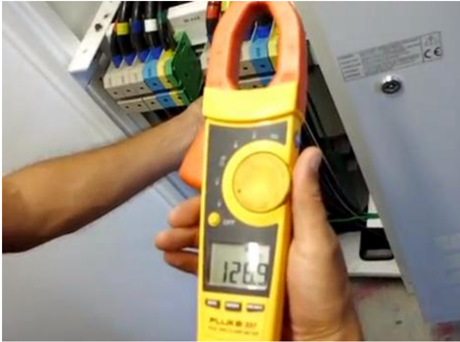
Figura 3.27 – Medición de voltaje de salida de fase a neutro.
