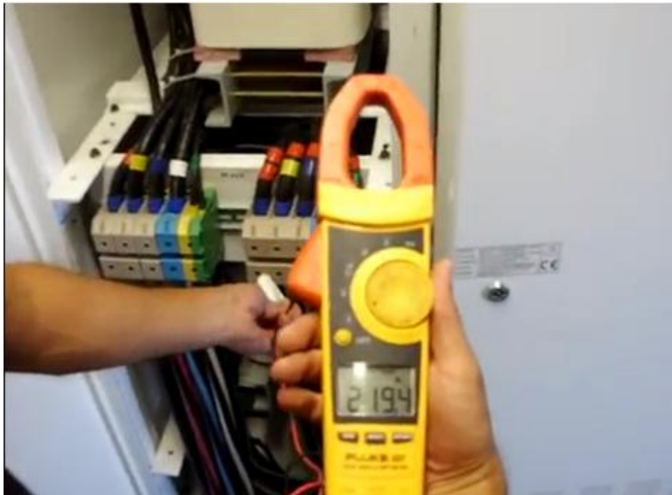
Figura 3.26 – Medición de voltaje de salida de fase a fase.
