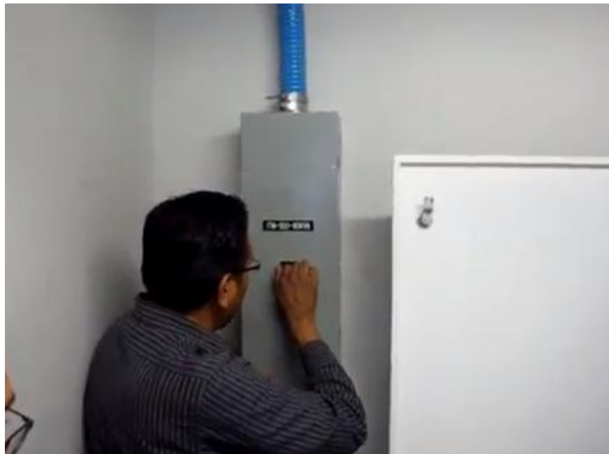
Figura 3.24 - Abertura del interruptor de la alimentación eléctrica
