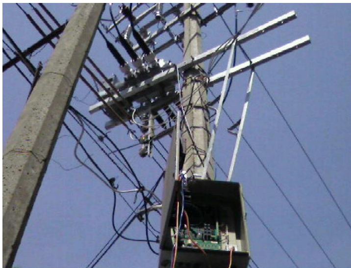
Figura 2.2 Punto de seccionamiento instalado en área urbana, 15 kv.
