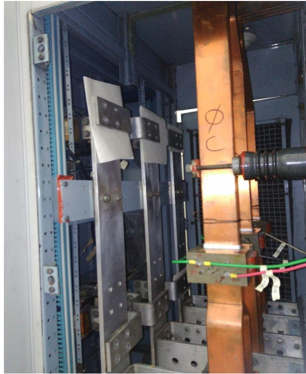
Figura 3.21. Gabinete y barras de C.A. unidad auxiliar.
