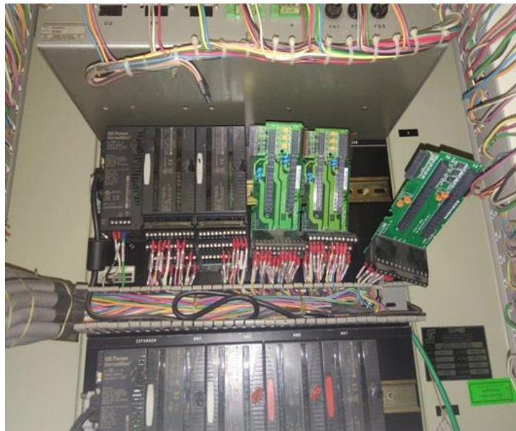
Figura 3.38. Tarjetas de entradas y salidas del PLC dañadas del módulo remoto AVR.
