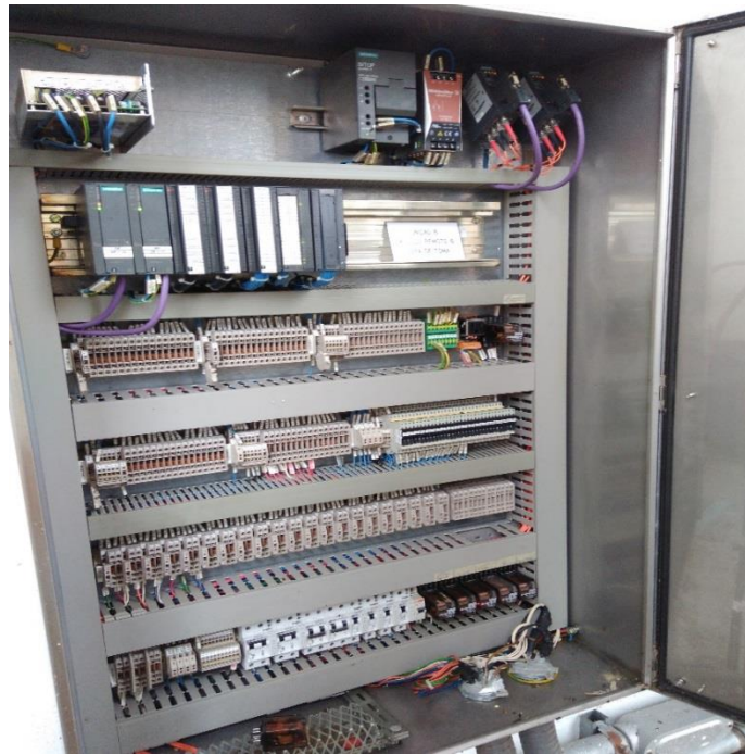
Figura 3.34. Modulo remoto obra de toma.
