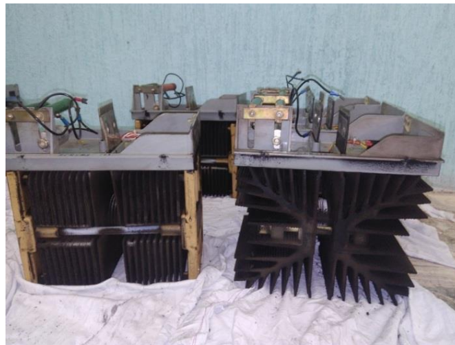
Figura 3.8. Tiristores antes del mantenimiento preventivo.
