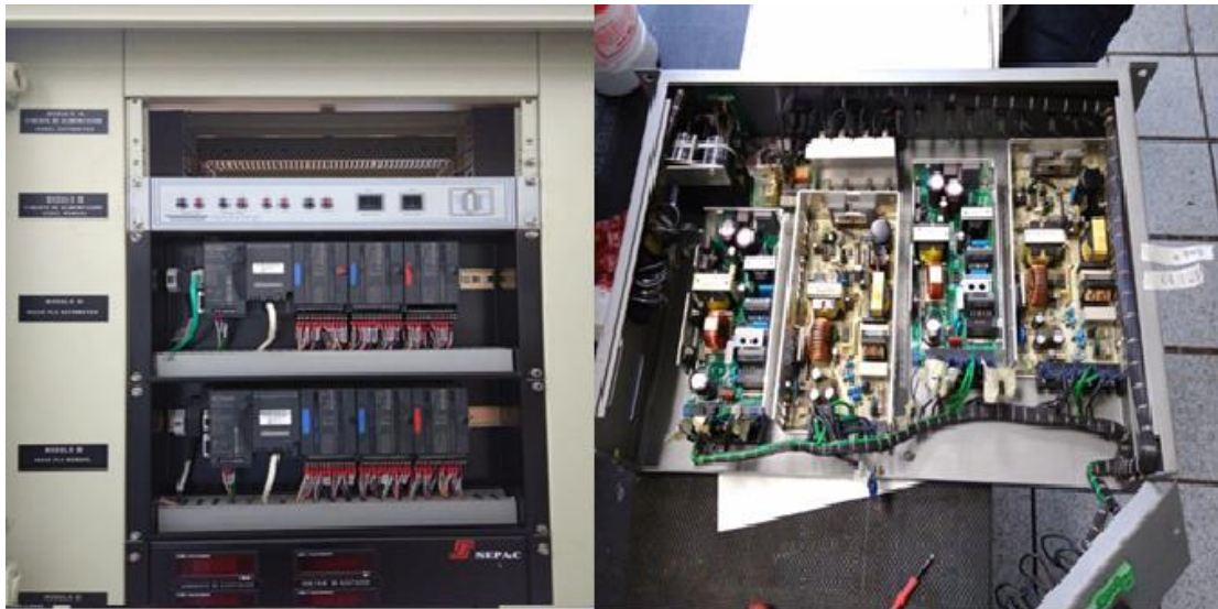
Figura 3.39. Mantenimiento a la fuente de alimentación del canal automático del módulo remoto AVR.
