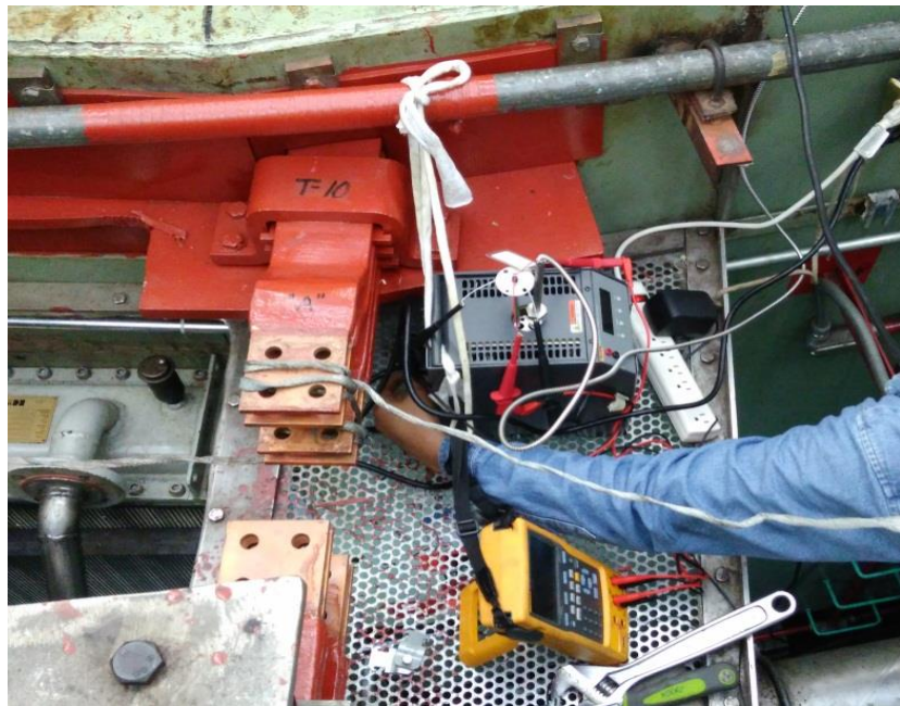
Figura 3.26. Calibración de sensores capilares aire frio del generador.
