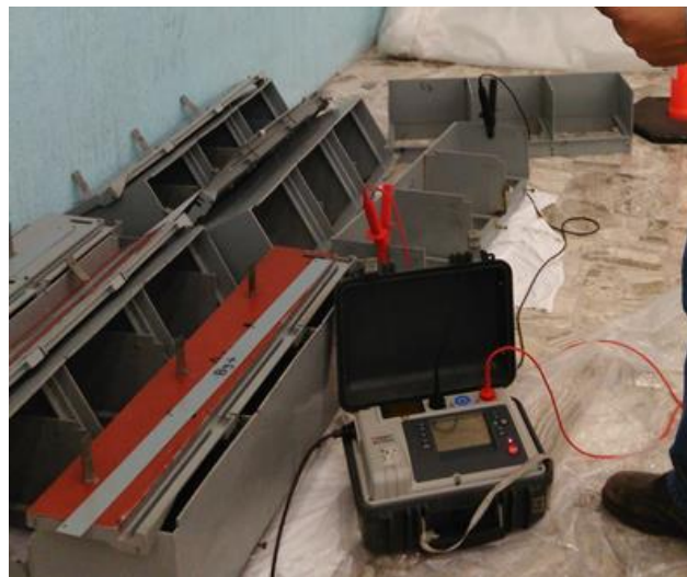
Figura 3.15 prueba de resistencia aislamiento a cuna de tiristores.
