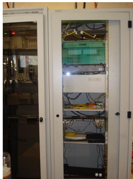
Fig.39.- Gabinete de comunicaciones
