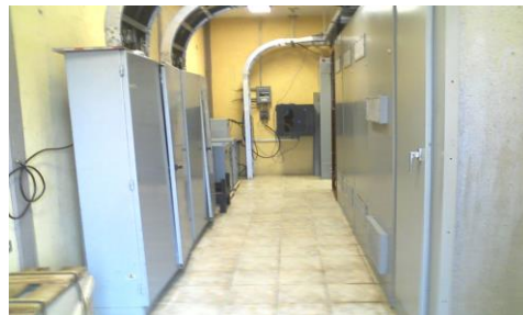
Fig.31.- Caseta de control S.E MCL
