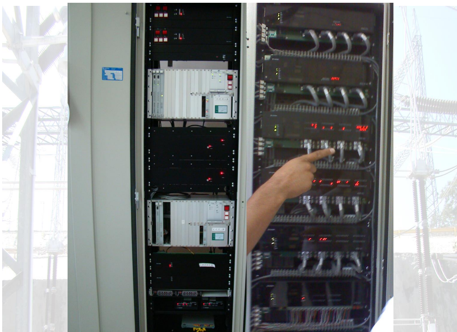
Figura 9.10: UTR de la Subestación Angostura y sus módulos Periféricos D20s.
