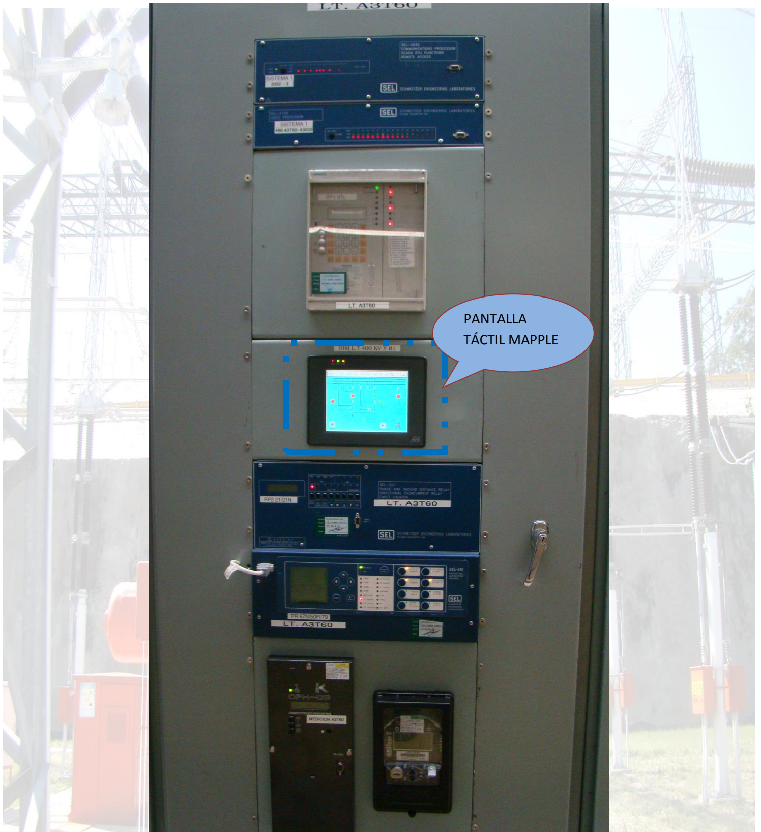
Figura 9.7: Equipos SEL para la modernización de la LT-A3T60.
