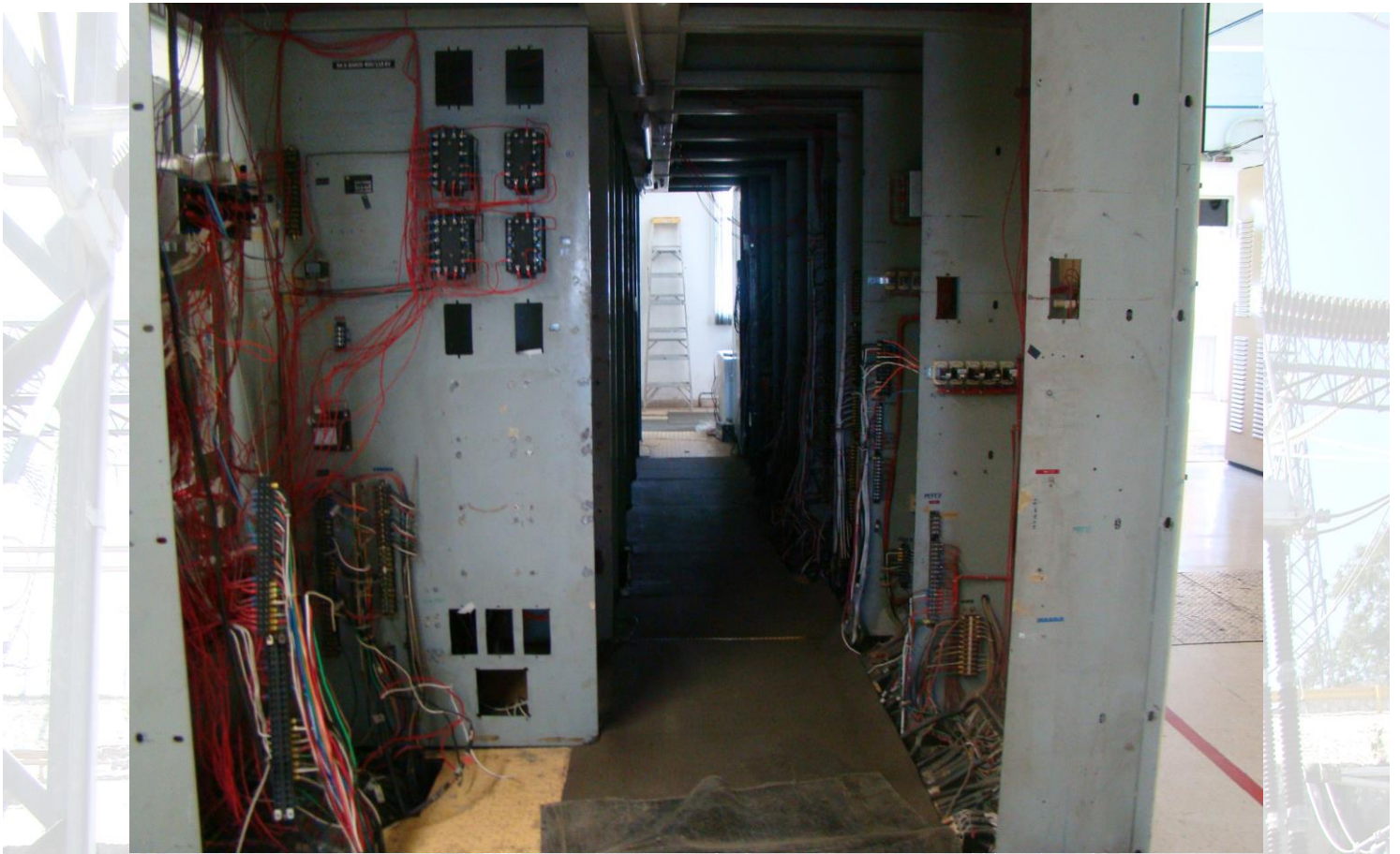
Figura 3.1: Cableado de las señales del área de 400 kV, antes de la modernización en el tablero dúplex.
