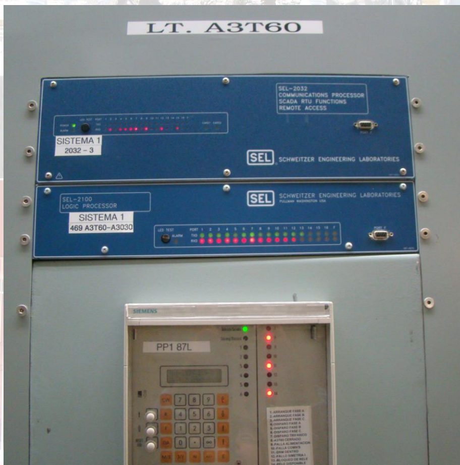
Figura 9.5: Ubicación de los equipos SEL2032-3 y SEL2100-4 en el tablero simplex.
