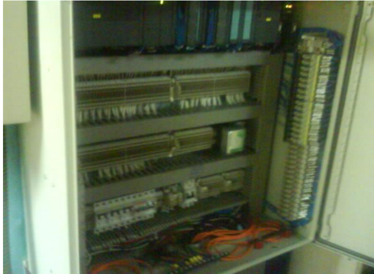
Figura 3.3.2: gabinete concentrador de RTD's
