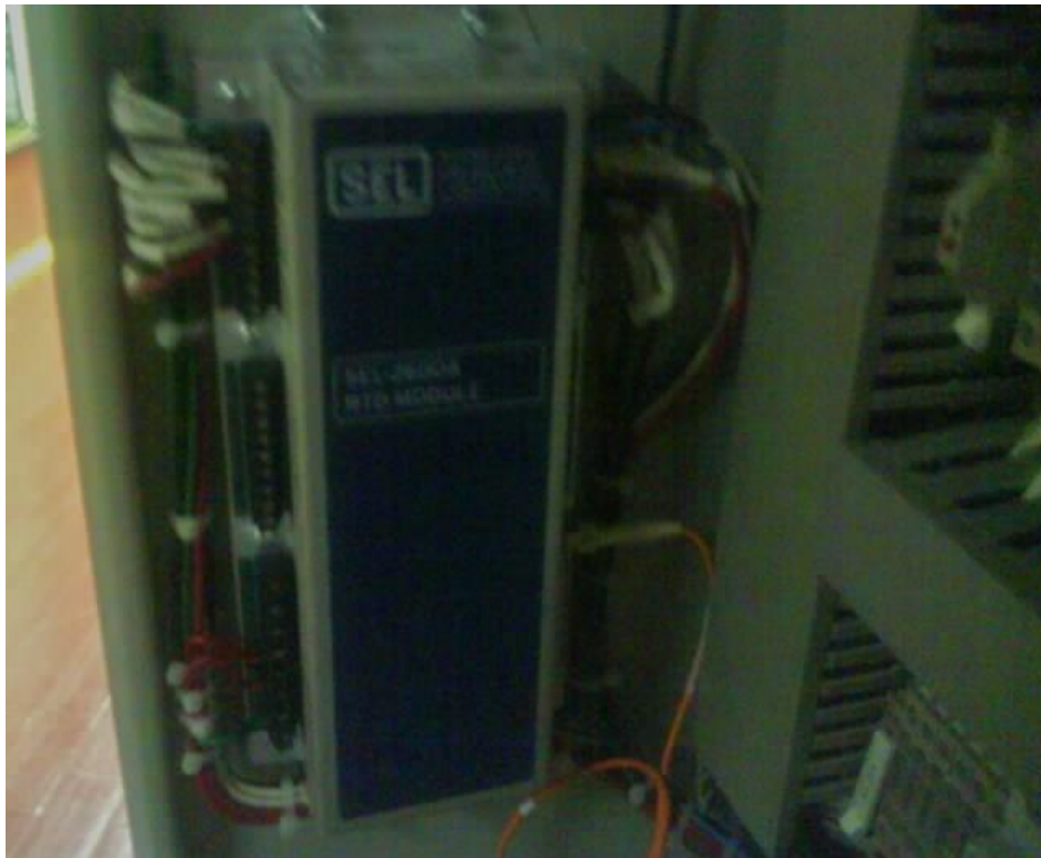
Figura 3.3.1: montaje del sel_2600 en su gabinete.
