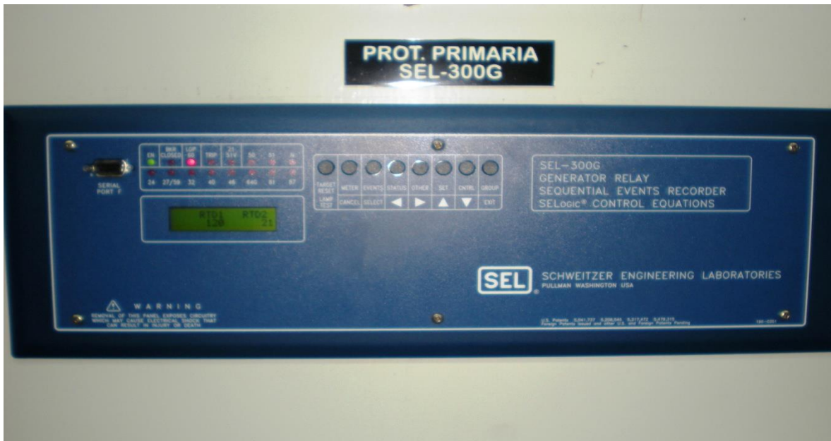
Figura 3.4: SEL-300G montado en lugar correspondiente de área de tableros.
