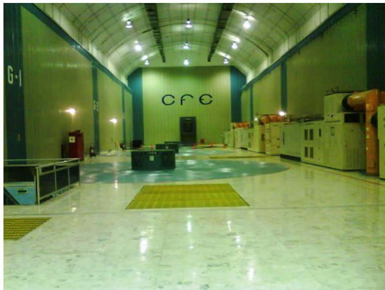
Figura 2: Casa de maquinas.
