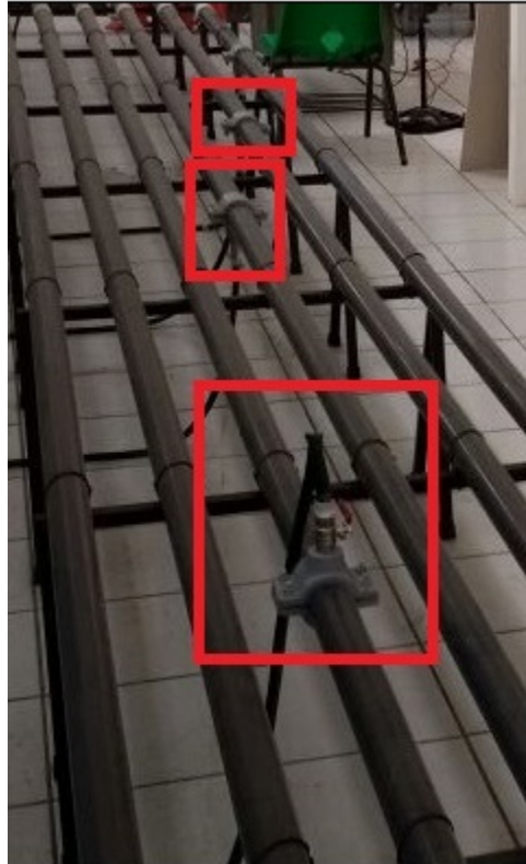
Figura 5.6: Ubicación de las válvulas
