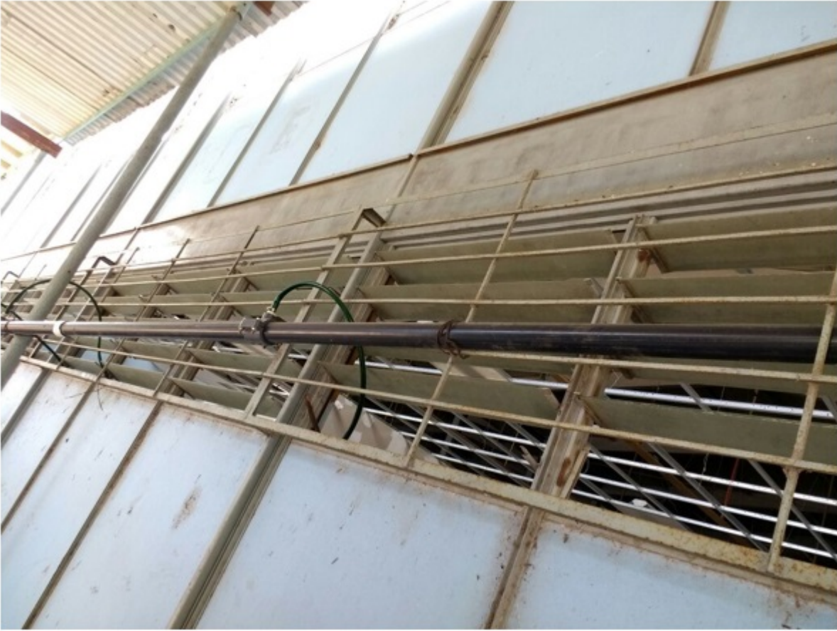
Figura 5.7: Desembocadura de flujo “fugas”
