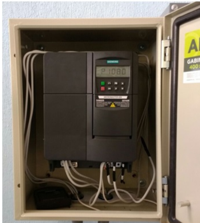
Figura 5.4: Variador de frecuencia
