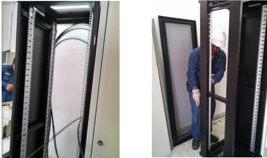
Figura 4.12 Montaje del gabinete del proyecto (REI).
