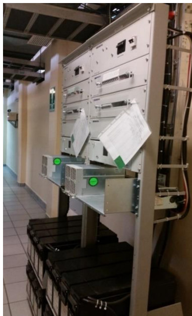
Figura 4.11 Sistemas de Fuerza de 48 VCD y Centro de Carga de 127 VCA
