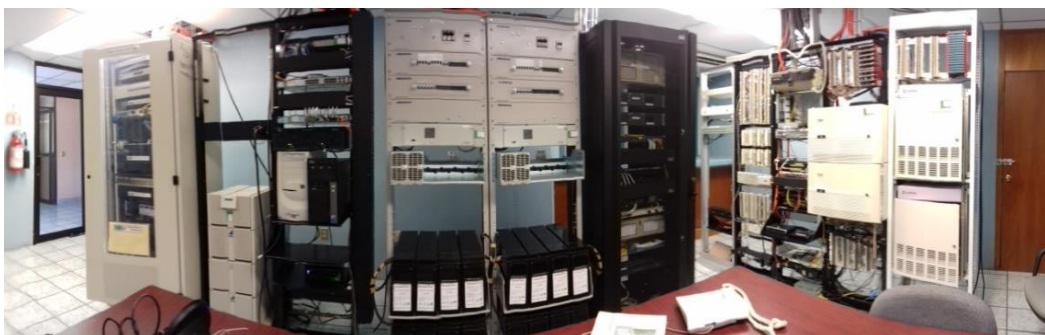
Figura 4.3 Sala de equipos Gerencia Regional Tuxtla
