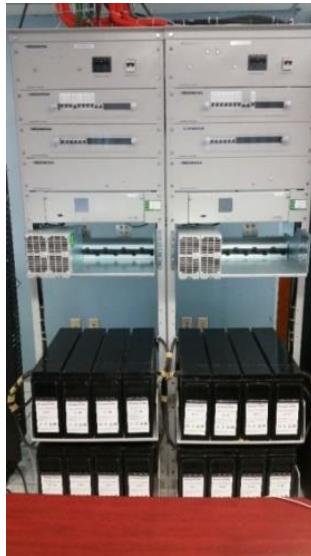
Figura 4.6 Sistema de fuerza de 48 Vcc y Centro de carga general de 220vca.
