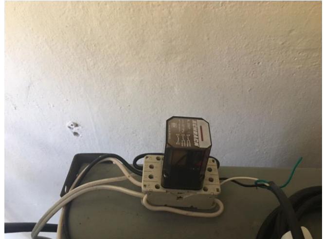
Figura 3.36 Relevador Shrack conectado al rectificador FRAT-48.
