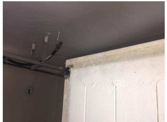
Figura 3.38 Sensor de presión instalado en la puerta de la caseta "La Pedrera".
