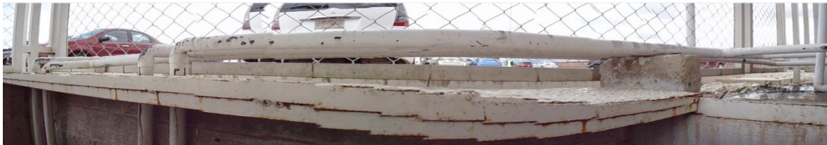
Fig. No 19.- Tubería sin ningún tipo de inclinación
