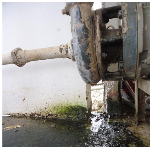
Fig. No 18.- Bomba con fuga por daño en el empaque
