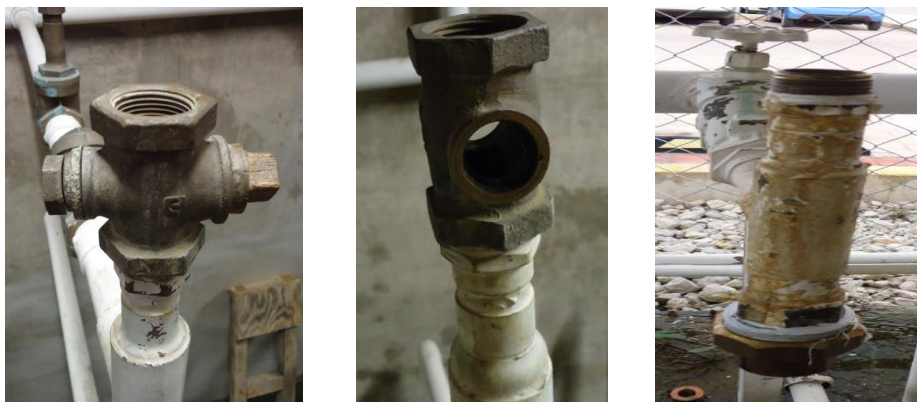
Fig. No 24.- Válvulas de paso dañadas y sin palanca de abertura
