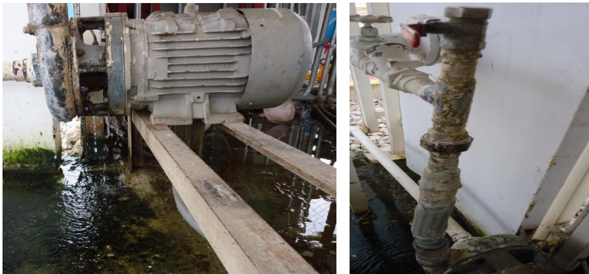
Fig. No 16.- Bomba y tubería con exceso de sarro
