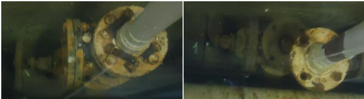
Fig. No 23.- Válvulas check instaladas de manera vertical
