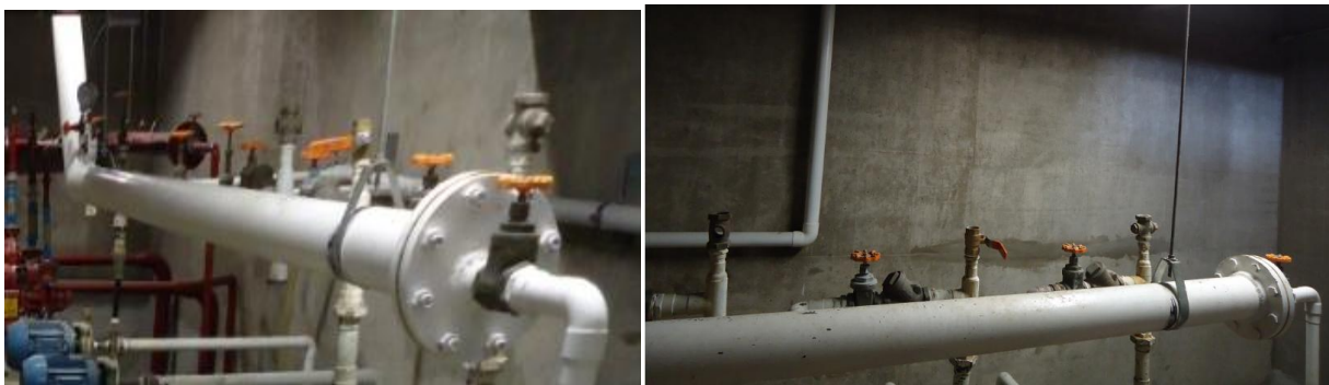
Fig. No 22.- Tubería sin soporte estable
