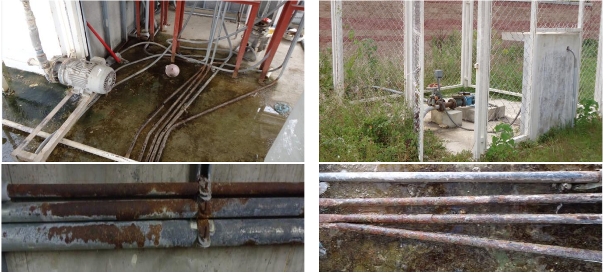
Fig. No 26.- Cables y tuberías en mal estado
