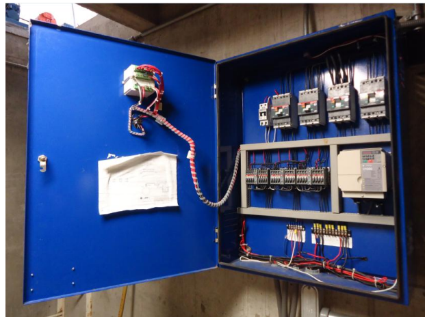
Fig. No 25.- Tablero del PLC
