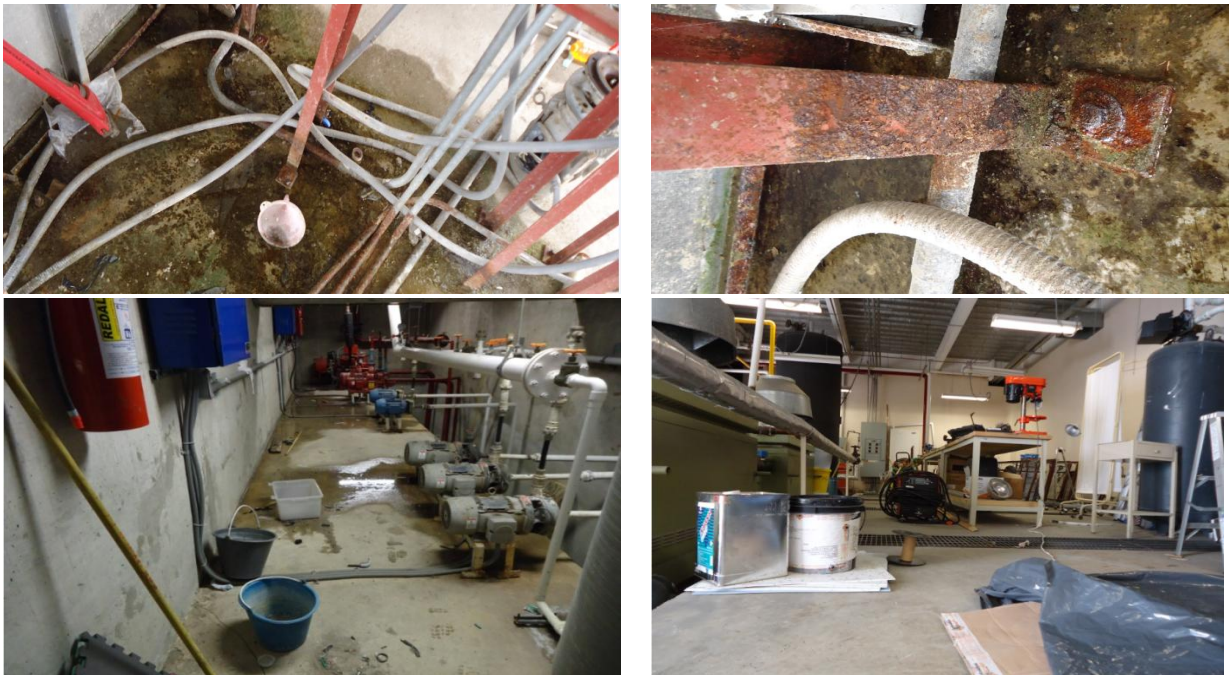
Fig. No 27.- Área de trabajo desordenada, tubería y cables en mal estado
