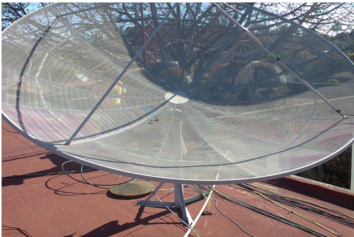
Fig.3.18 ANTENA PARABOLICA DE RECEPCIÓN
