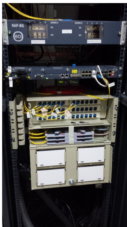
ILUSTRACIÓN 88- RAP-BG EN LA PARTE SUPERIOR DEL RACK
