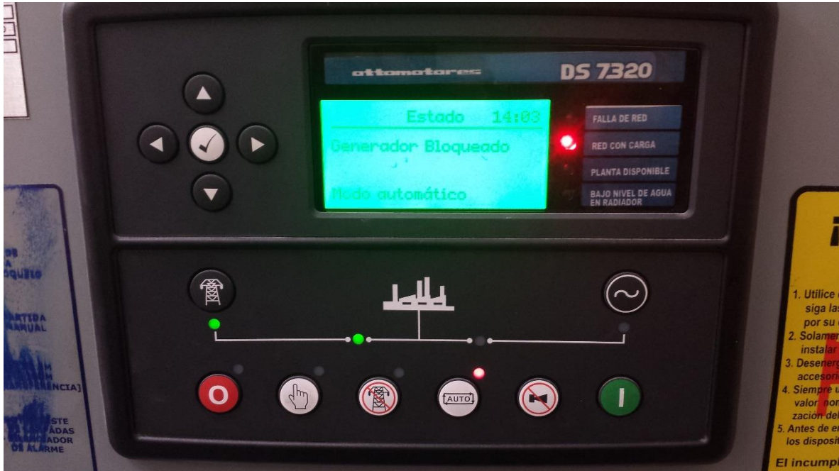
ILUSTRACIÓN 75-PANEL DE CONTROL DE LA PLANTA
