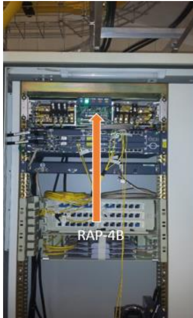
ILUSTRACIÓN 80-LOCALIZACIÓN DE EQUIPO RAP-4B
