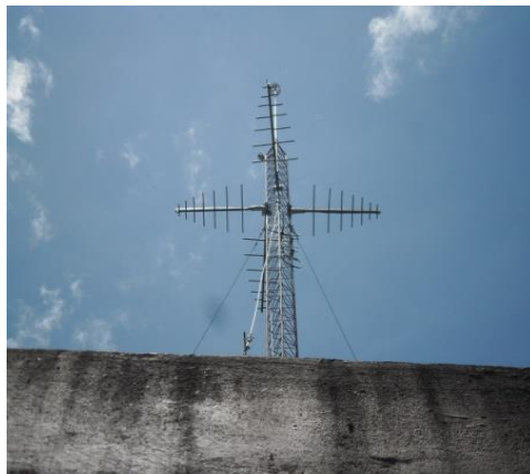
Figura 1.8 Torre transmisora y antenas marca Yagi.
