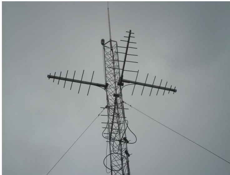
Figura 5.6 Torre de transmisión.
