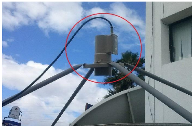
Figura 4.17 LNB de la Antena.
