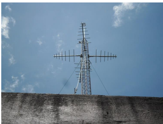
Figura 5.25 Torre transmisora y antenas marca YAGI.
