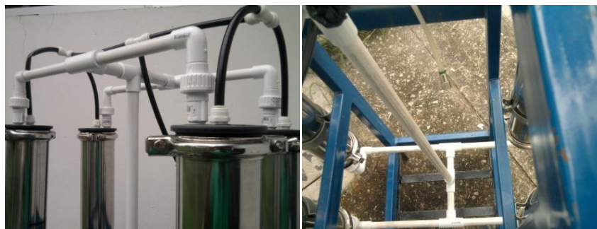
Figura 15. Conexiones de tuberías y mangueras.
