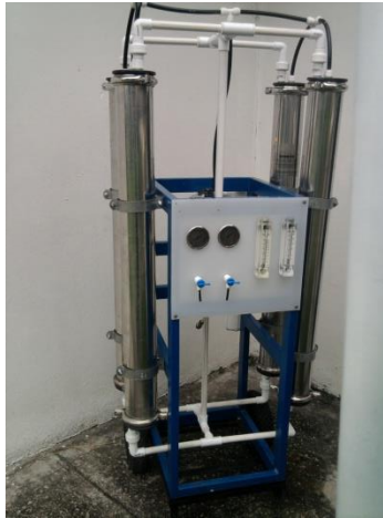
Figura 16. Armado final del sistema de nanofiltración.
