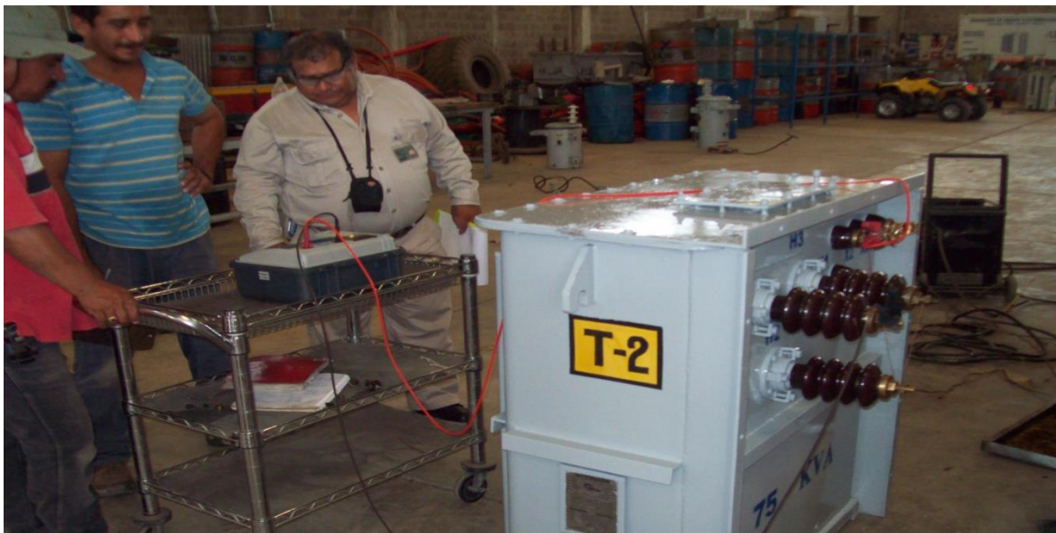
FIGURA 20 MEDICION DE RESISTENCIA DE AISLAMIENTO CON MEGGER
