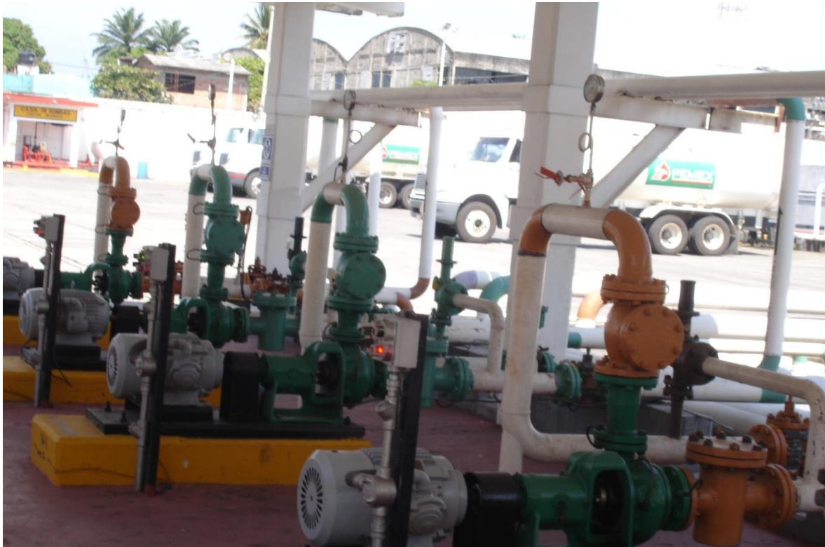
FIGURA 16 CASA DE BOMBAS
