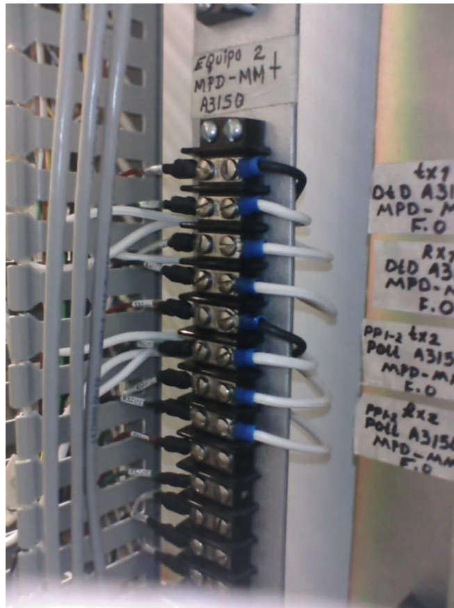
Figura 3.3.8 Conexión de los cables, hacia nuestros esquemas de protecciones.
