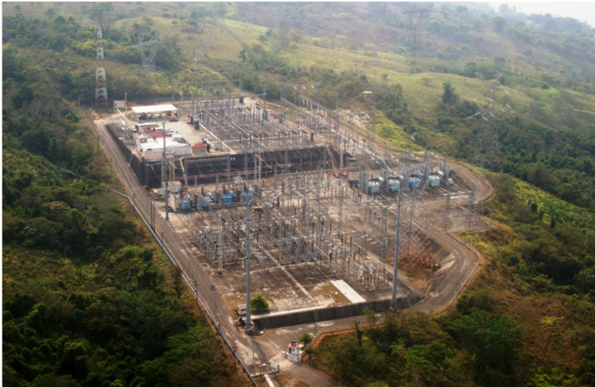
Figura 1.3.4 Subestación Eléctrica Malpaso Dos
