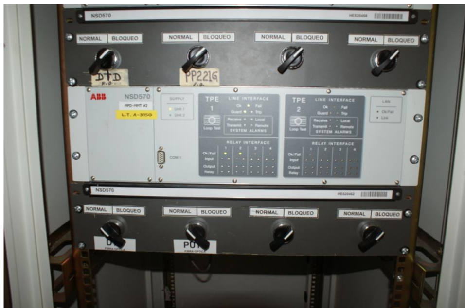
Figura 3.3.3 Equipos NSD570 y conmutadores de bloqueo.
