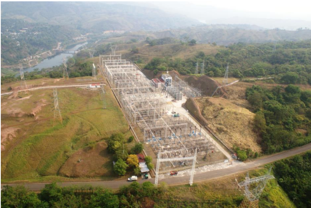
Figura 1.3.3 Subestación Eléctrica Malpaso Uno
