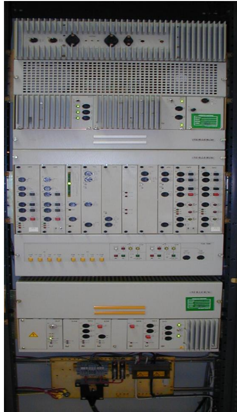
Figura 4.2.2.2 Equipos OPLAT ESB500 y SWT500 F6
