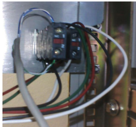
Figura 3.5.12 Cableado de los conmutadores de bloqueo hacia las tablillas de contactos del Supervisorio.
