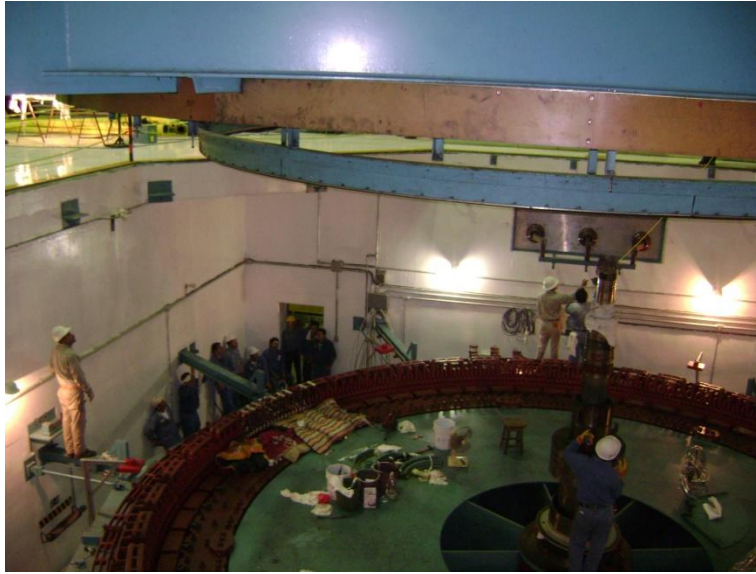
Fig 2.2.1.4.3 .- Generador de una unidad de la C.H.A.A.C. en mantenimiento.
