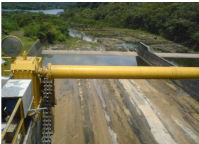
fig 2.2.1.1.3.- canal de vertedores
