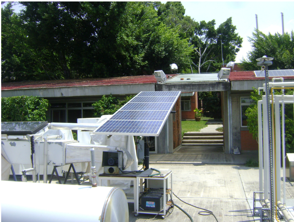
Fig. 7 Sistema solar fotovoltaico
