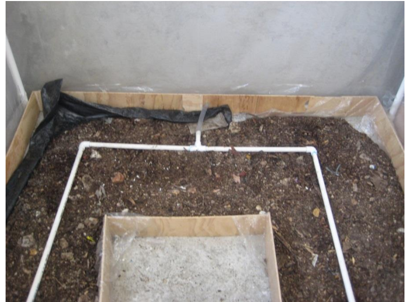
Conexión del sistema de riego
