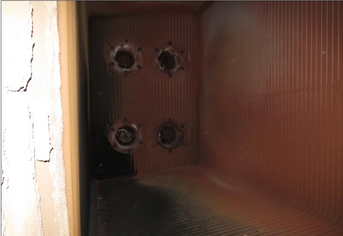
Quemadores y Paredes de Tubos de Agua, de la Caldera Auxiliar BB-101.
