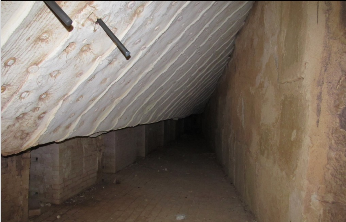
Vista Interna del Ducto de salida de los Gases de Combustión o Cono. En la Esquina Superior Izquierda Termopares.
