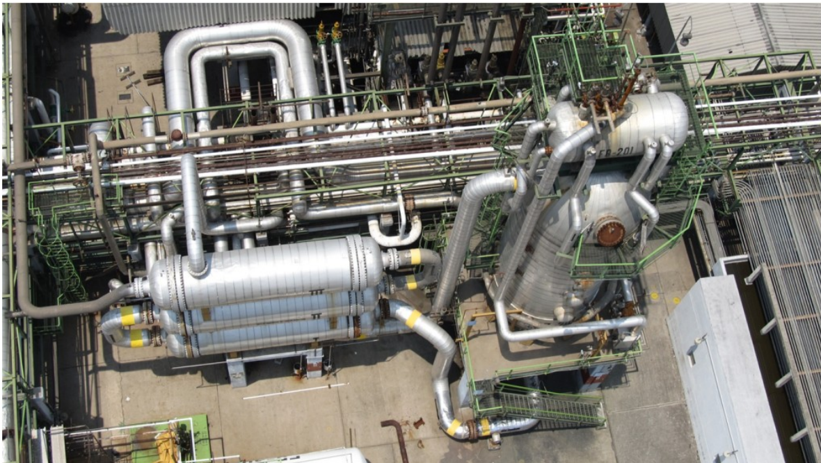
Intercambiadores de calor EA-201-I-II-II, Reactor de Metanol DC-201 y Tambor de Vapor FB-201.
