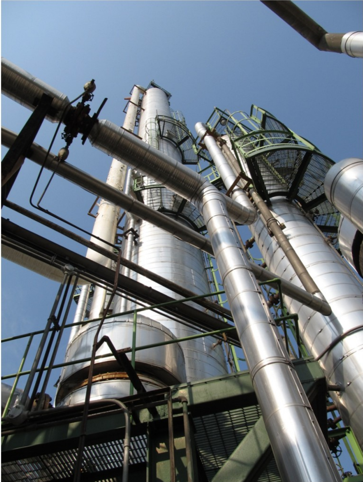
Torre de Destilación de Metanol DA-302.
