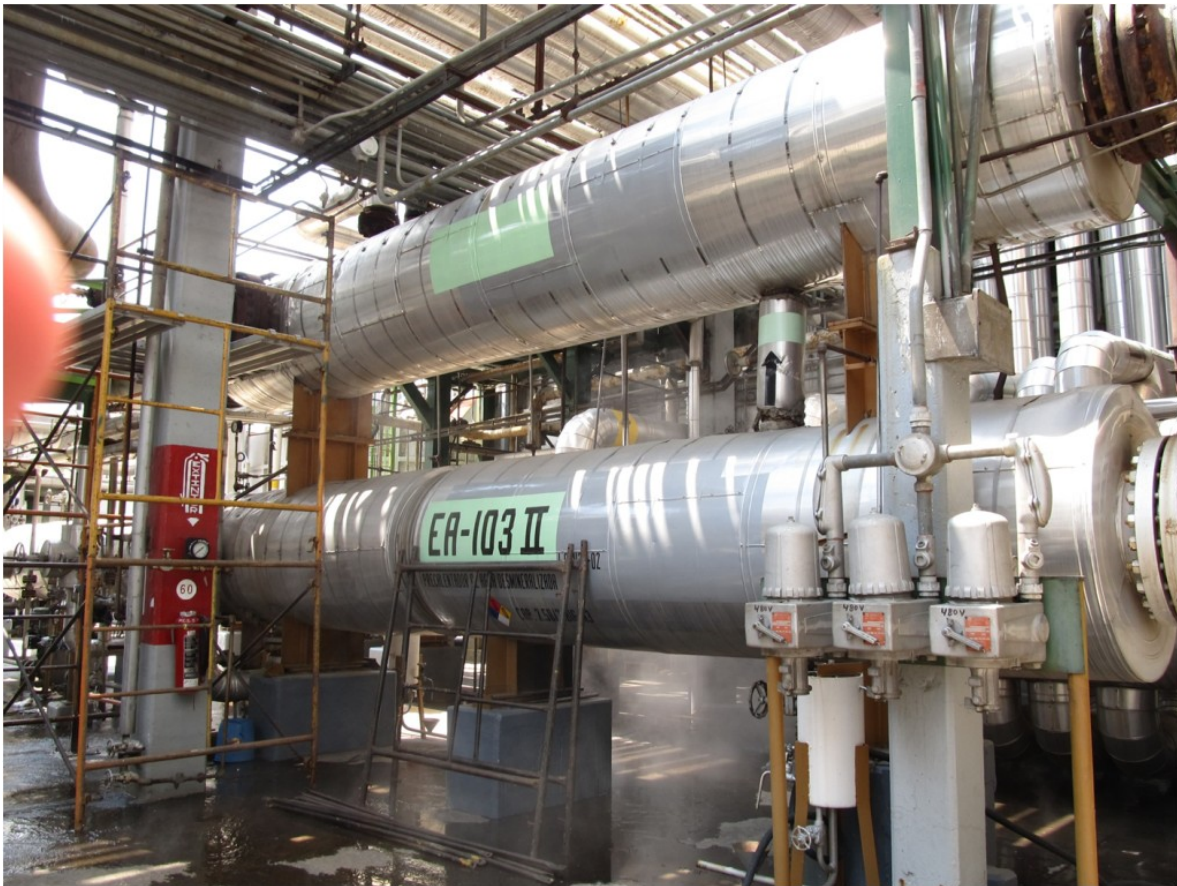
Intercambiadores de Calor EA-103-I y EA-103-II, del tren de recuperación del calor del gas Reformado, durante rotulación dentro del periodo de paro de planta.
