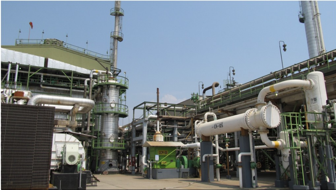
Atrás Horno Reformados, adelante y de izquierda a derecha: Soplador GB-101, Desulfurizadoras, Enfriador final de Gas de Síntesis, separador de condensado, atrás y a la derecha Enfriadores Soloaires.
