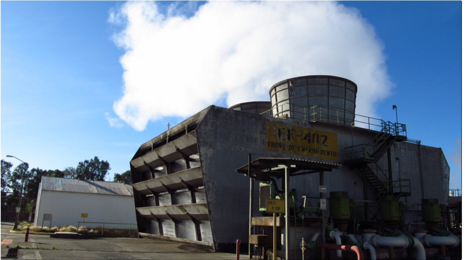
Torre de Enfriamiento de Tipo Tiro Inducido y Flujo Cruzado. EF-402. Durante Operación Normal de la Planta.
