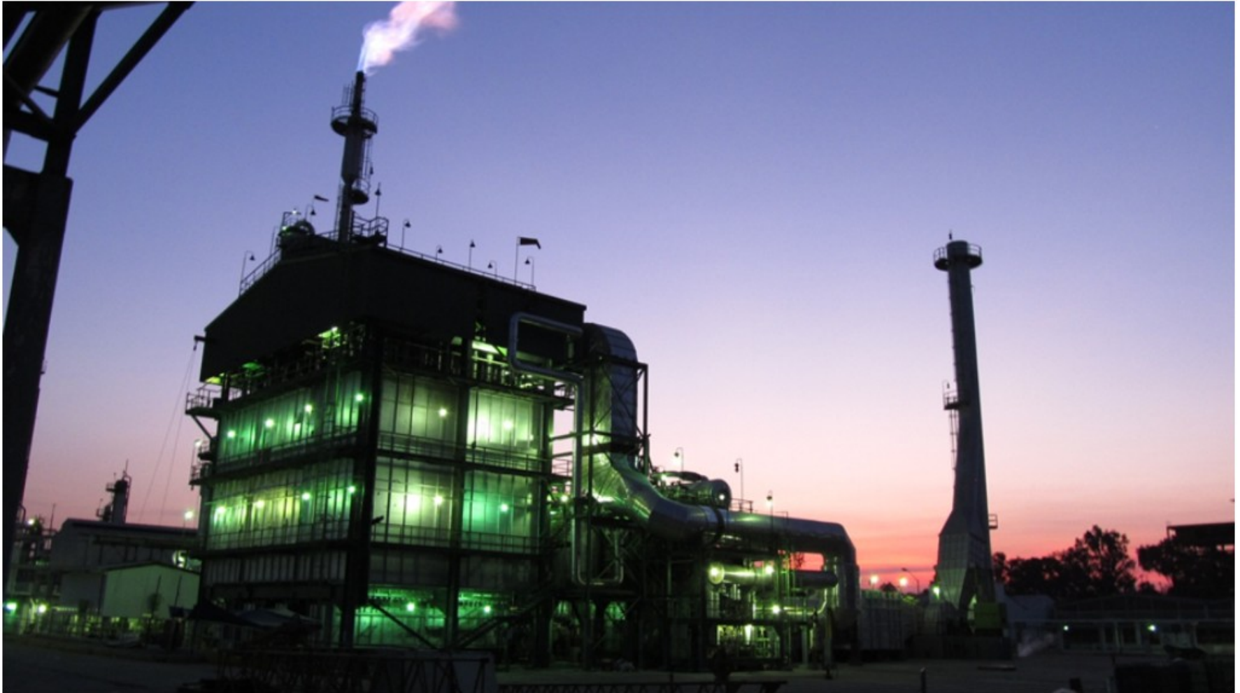
Vista Nocturna de la Unidad de Reformación de la Planta Metanol II, Flare encendido durante quema de carga antes del arranque del turbo-compresor GTC-101 durante un arranque programado de la planta.
