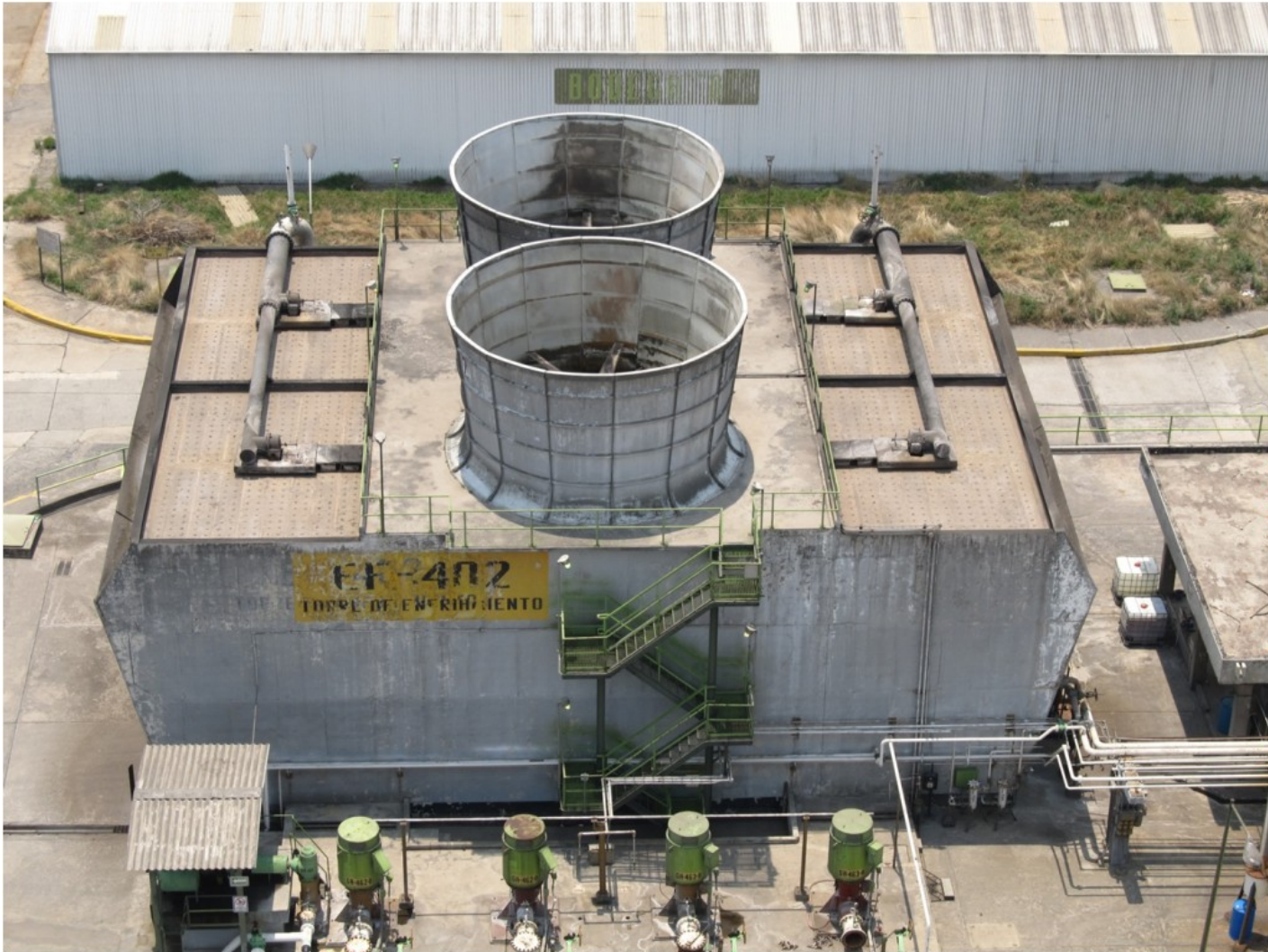
Torre de Enfriamiento EF-402. Se observa los dos ventiladores de tiro inducido, la llegada del agua caliente a los lados y sus dispersores y en la parte inferior las bombas para circulación.
