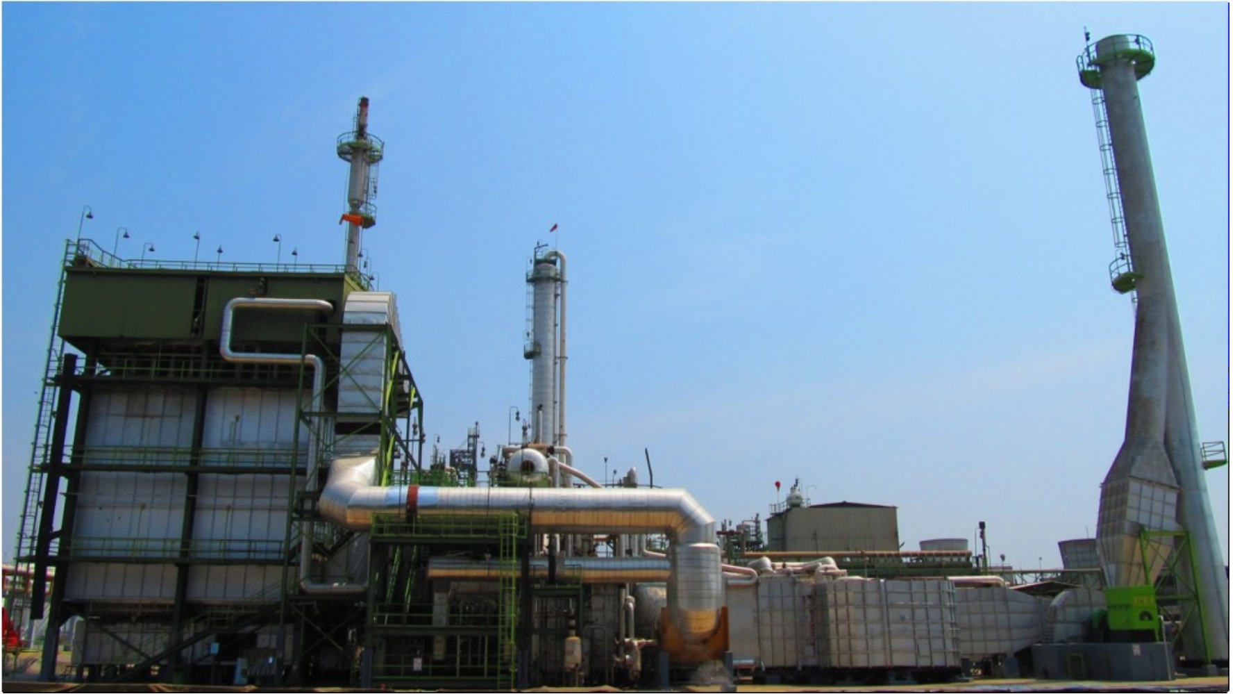
Vista del Reformador Tubular y del Tren de Recuperación de Calor de los Gases de Combustión, del Soplador Tiro Inducido y de la Chimenea. Atrás Flare y Columna de Destilación.
