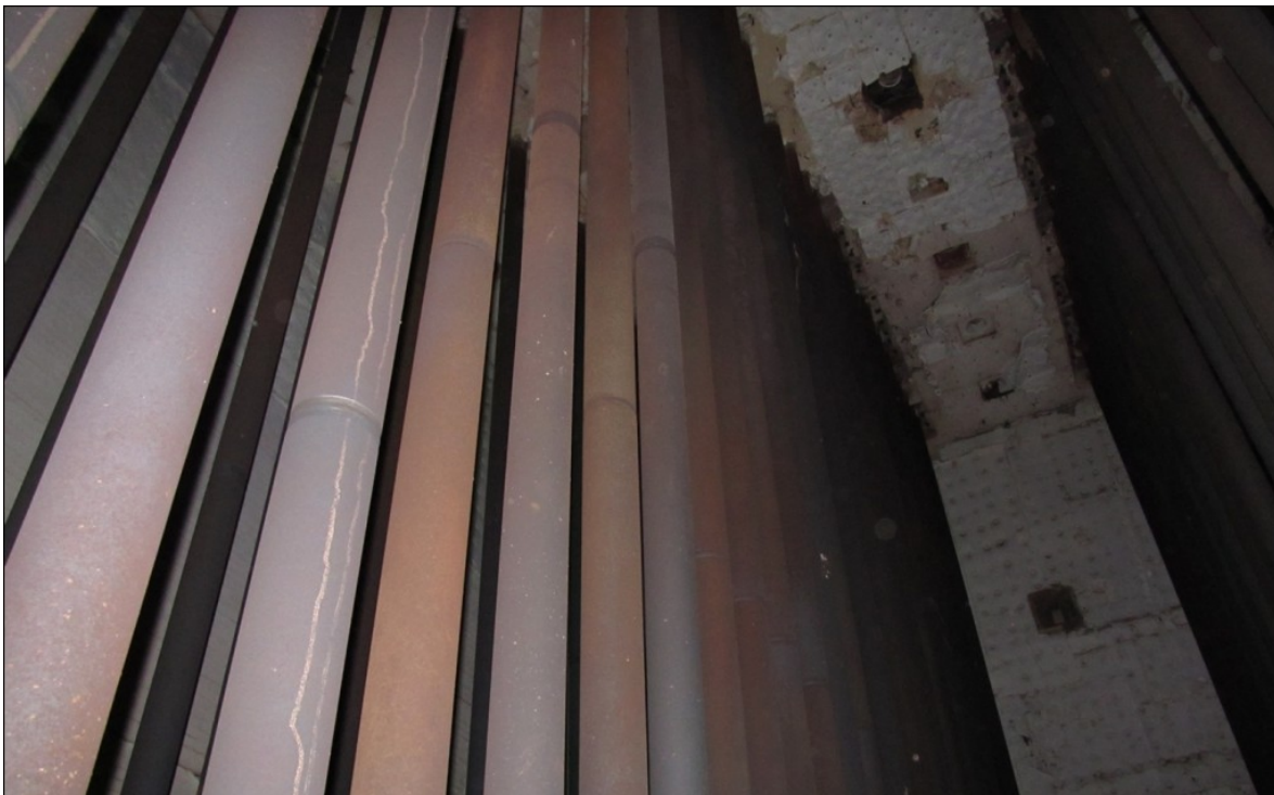
Interior del Reformador BA-101 . Arriba Quemadores y material refractario, a los lados Banco de Tubos Catalíticos.
