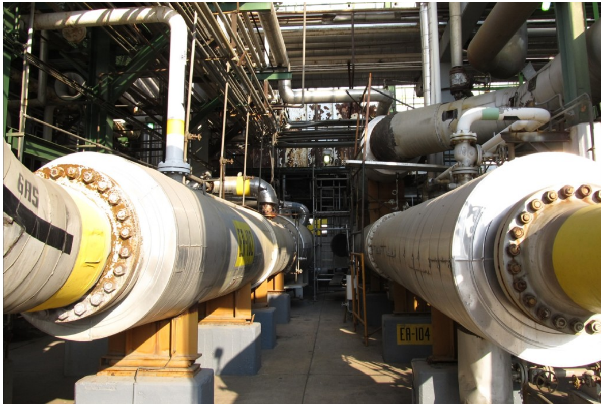
Tren de Recuperación del Calor del Gas Reformado.
