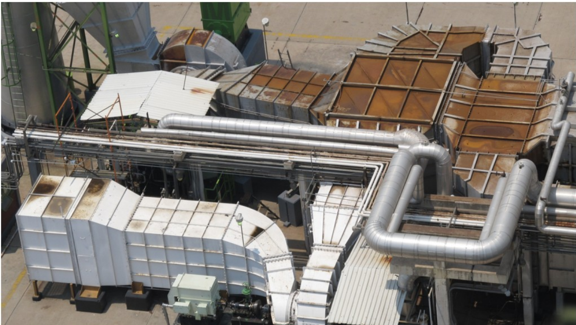
Detalle de los Sopladores GB-101 o Tiro Forzado (abajo y de blanco) y del GB-102 o Tiro Inducido ( en la parte superior , de color gris y con oxido).
