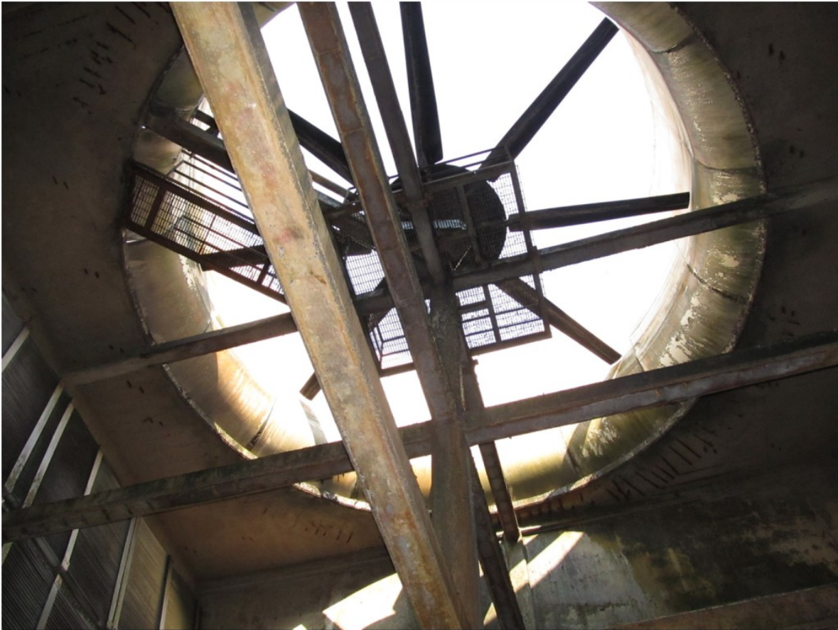
Soplador Tiro Inducido dentro de la Torre de enfriamiento.
