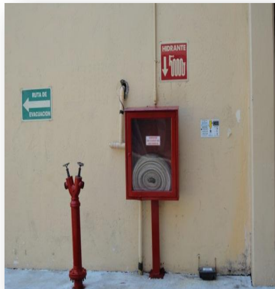
Fig. 10 Hidrantes para la protección contra incendios
