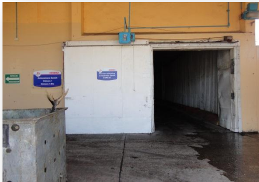
Fig. 15 Señalización de las cámaras de congelación.
