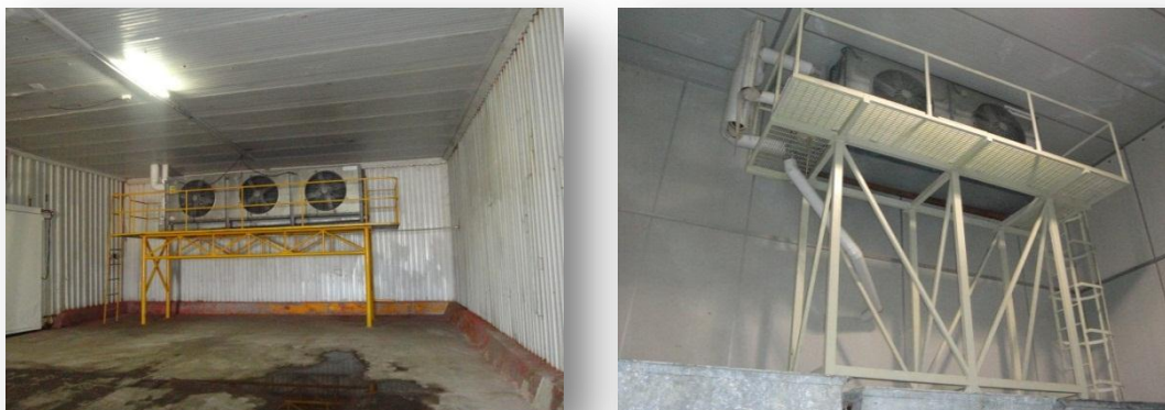
Fig. 3 Evaporadores para el sistema de congelación.
