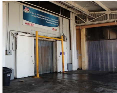
Fig. 16 Puerta de acceso para los montacargas.
