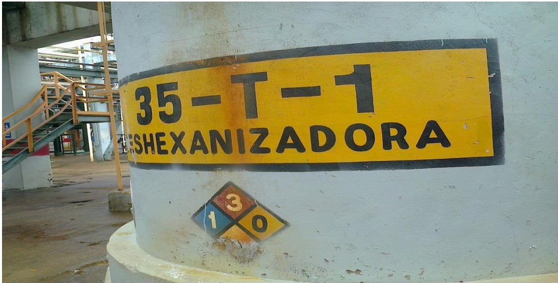
Torre Dehexanizadora 35-T-1.
