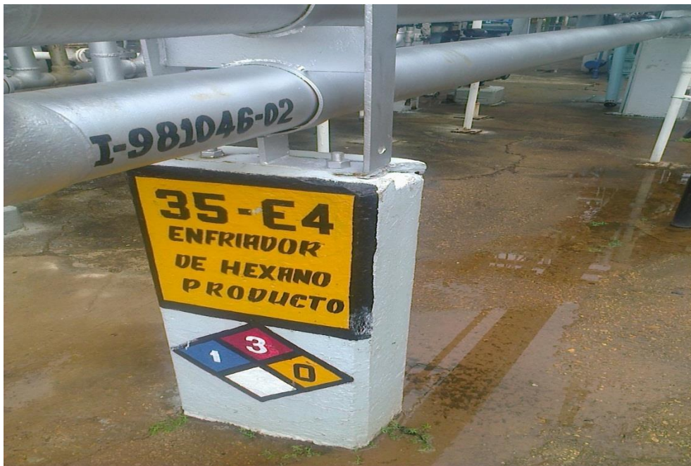
Intercambiador de calor para hexano 35-E-4.
