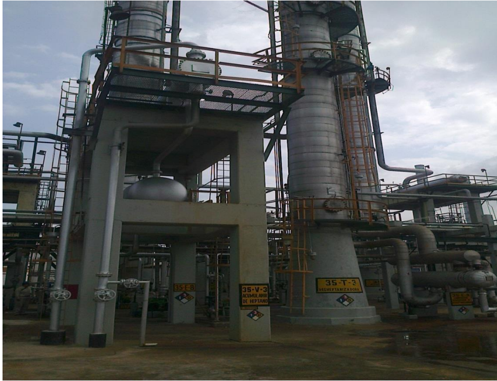
Torre Deheptanizadora II 35-T-3 y acumulador de heptano 35-V-3.
