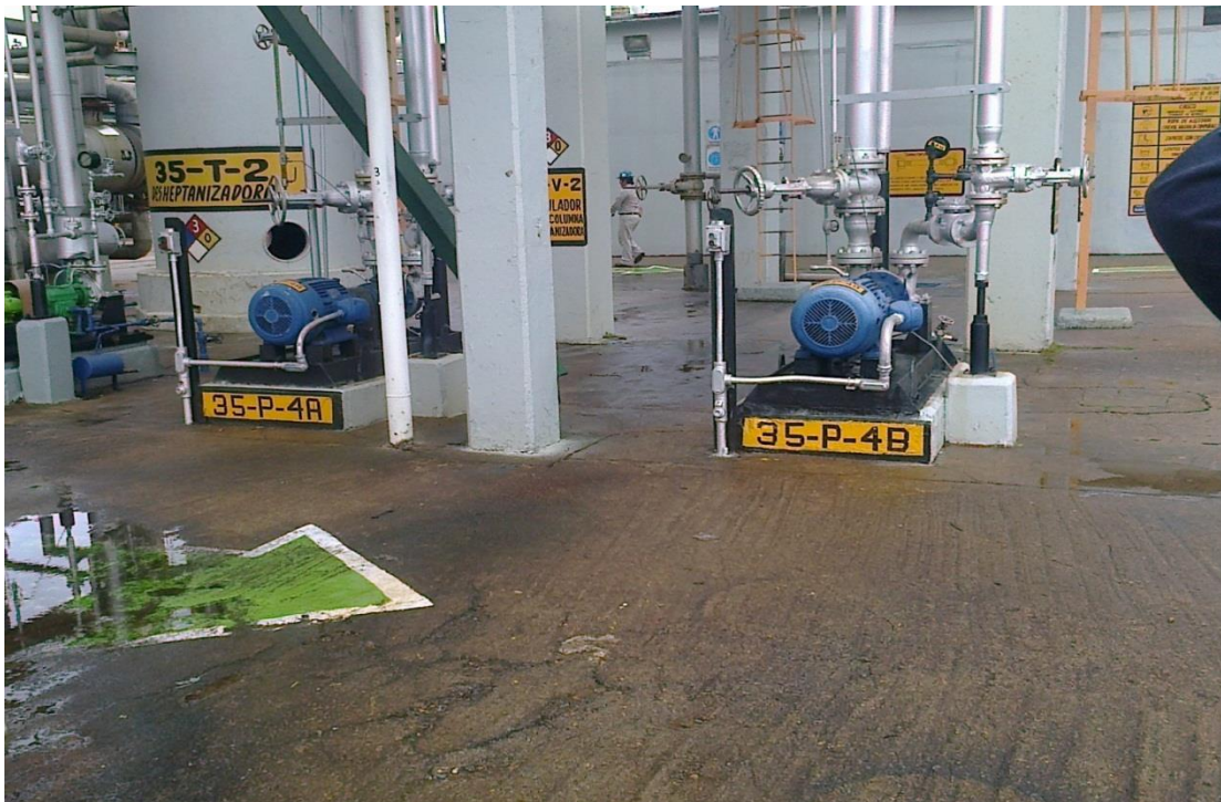
Torre Deheptanizadora I 35-T-2 y bombas 35-P-4.
