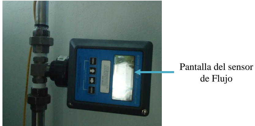
Figura 7.10 Pantalla del Medidor de Flujo
