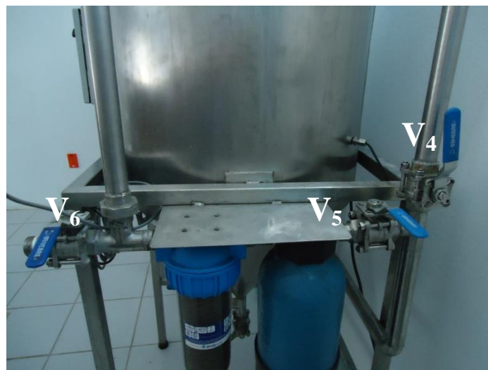
Figura 6.6 Ubicación de Válvulas laterales
