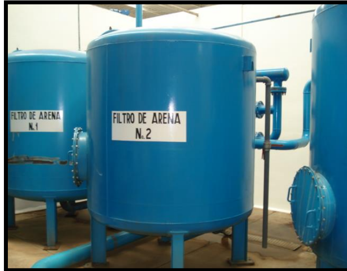
Imagen 7.1.4.1-2: Filtros de arena.
