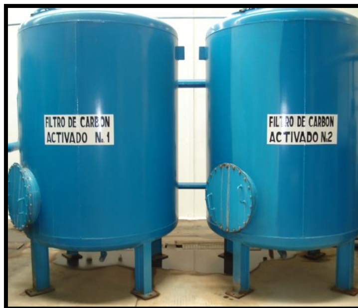
Imagen 7.1.4.1-3: Filtros de carbón activado.
