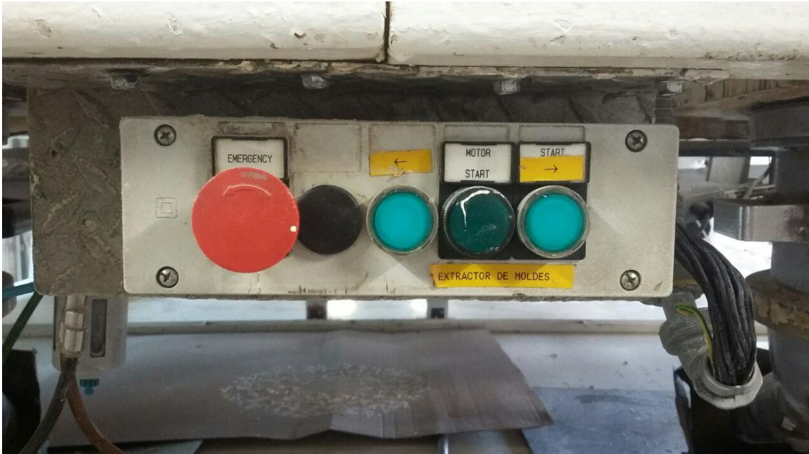
5. Control de extractor de moldes para cambio de formato.
