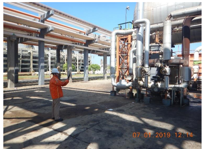
TOMA DE MUESTRA EN EL EXTERIOR DE LA PLANTA ALQUILACION VISCORREDUCTORA MTBE-TAME
