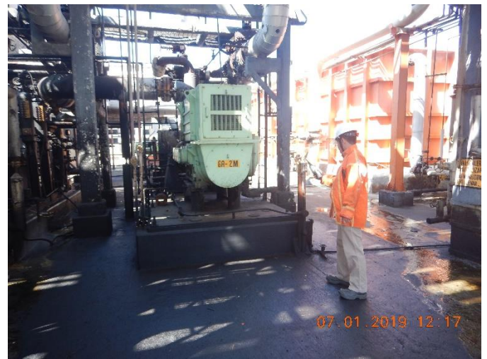
MEDICION DEL RUDIO EN LA BOMBA GA-2M QUE TIENE UNA FUERTE FUGA DE VAPOR
