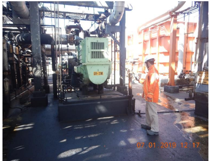
Toma de muestra a la bomba GA-2M, en un área de la planta viscorreductora MTBE-TAME.
