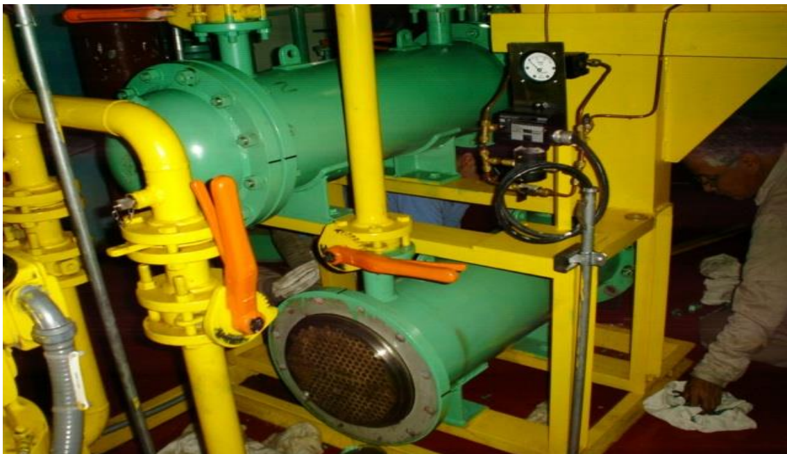
Fig.22.- Intercambiador de calor de carcasa y tubos. (Chumacera guía turbina)
