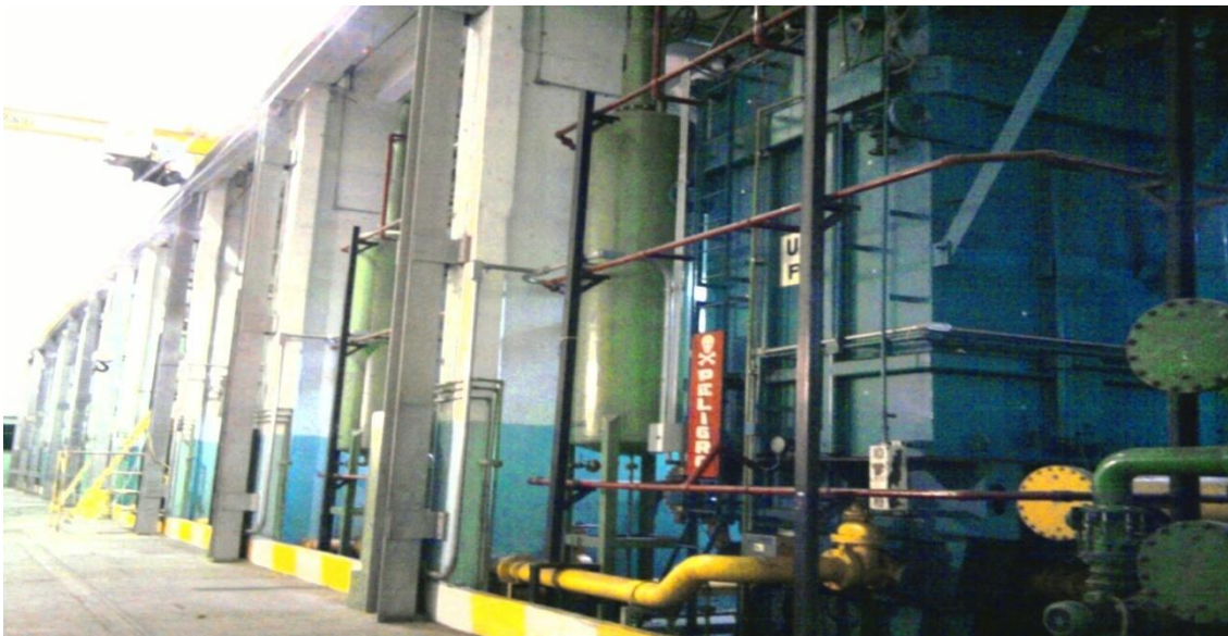
Fig. 10.- Pasillo de transformadores.
