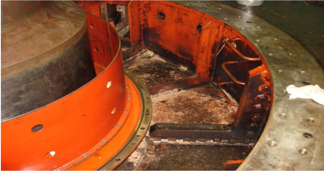
Fig. 18.- Vista interior de la cuba de la chumacera guía turbina
