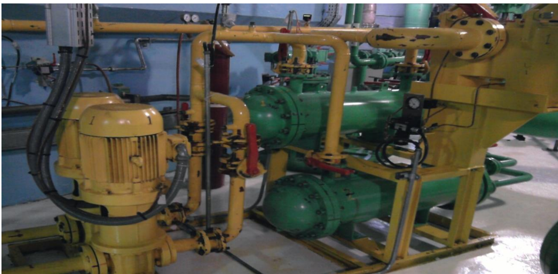
Fig. 19.- Dispositivo de enfriamiento de la chumacera guía turbina, que consta de: Dos bombas y dos intercambiadores de calor y un filtro para el aceite.
