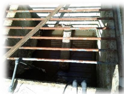
Figura 11 Cárcamo de descarga de aguas residuales de las instalaciones del CIDETEQ (Sitio de muestreo)
