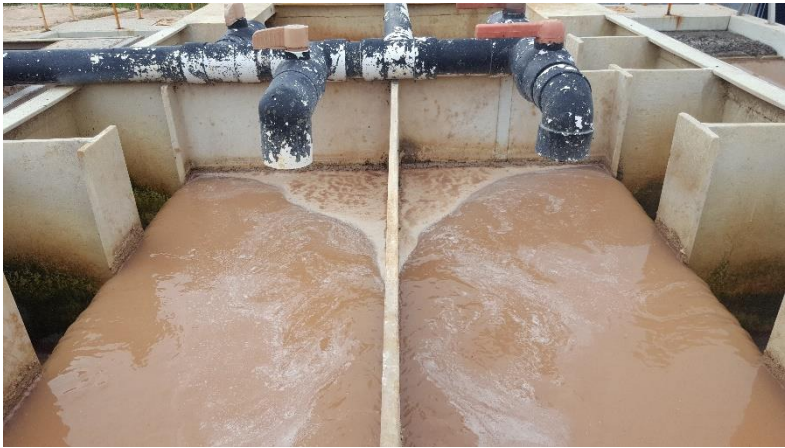
Figura 5. Caja primaria (Entrada de RAN's)
