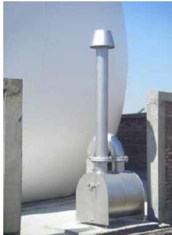
Imagen 10 Válvula de alivio (guarda hidráulica) en un gasómetro de doble membrana [2]
