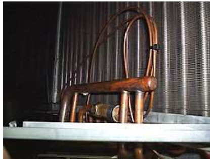
Fig. 2.8 Evaporador de serpentín aleteado al interior de equipo de aire acondicionado tipo Split (convección natural)
