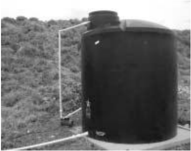
Figura 1.13 Tanque de polietileno de 5 m 3 , San Felipe del Progreso, Estado de México.
