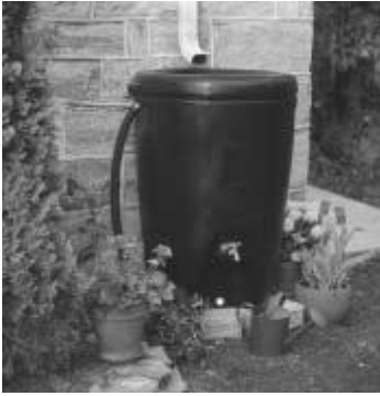
Figura 1.15 Tanque de recepción de las primeras lluvias.
