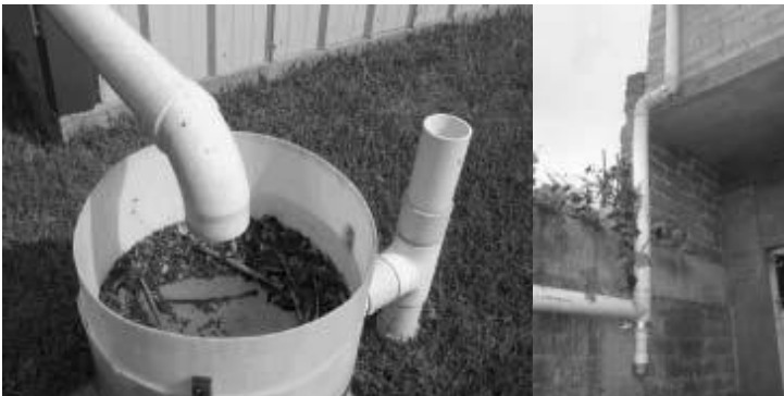
Figura 1.16 Trampa de basura para las primeras lluvias (izquierda) y válvula para drenaje (derecha).
