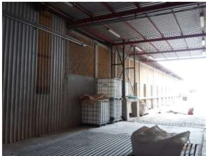
Ilustración 39. Área de almacenamiento de residuos.
