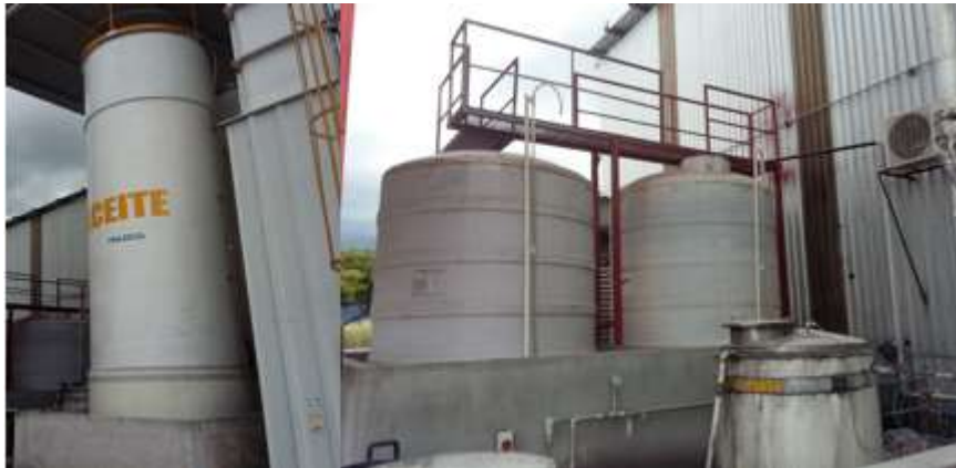
Ilustración 34. Área de almacenamiento de Grasa y Aceite
