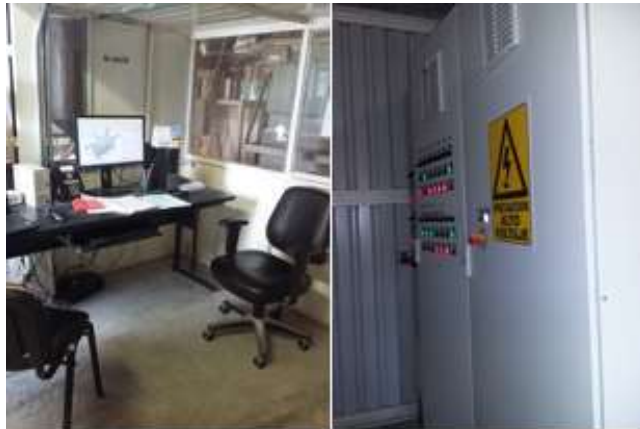
Ilustración 20. Equipos de control en el área de Producción
