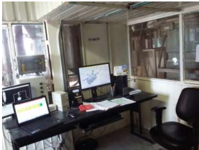
Ilustración 36. Interior del área de dosificación
