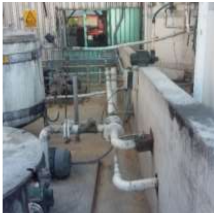
Ilustración 16. Tuberías de Grasa y Aceite
