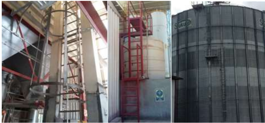
Ilustración 7. Escaleras y plataformas usadas en la Planta
