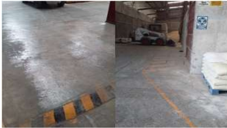
Ilustración 9. Pisos del área de producción y almacenamiento
