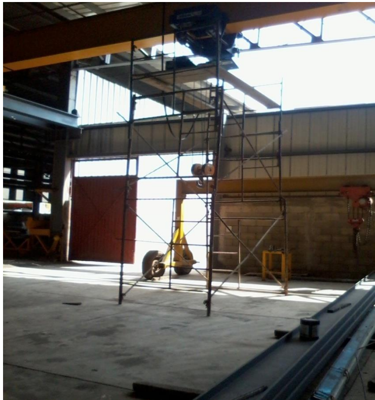
Fig. 5 Grúa viajera abus de 8 ton
