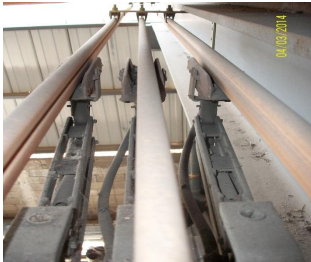
Fig. 26 Línea eléctrica de la grúa
