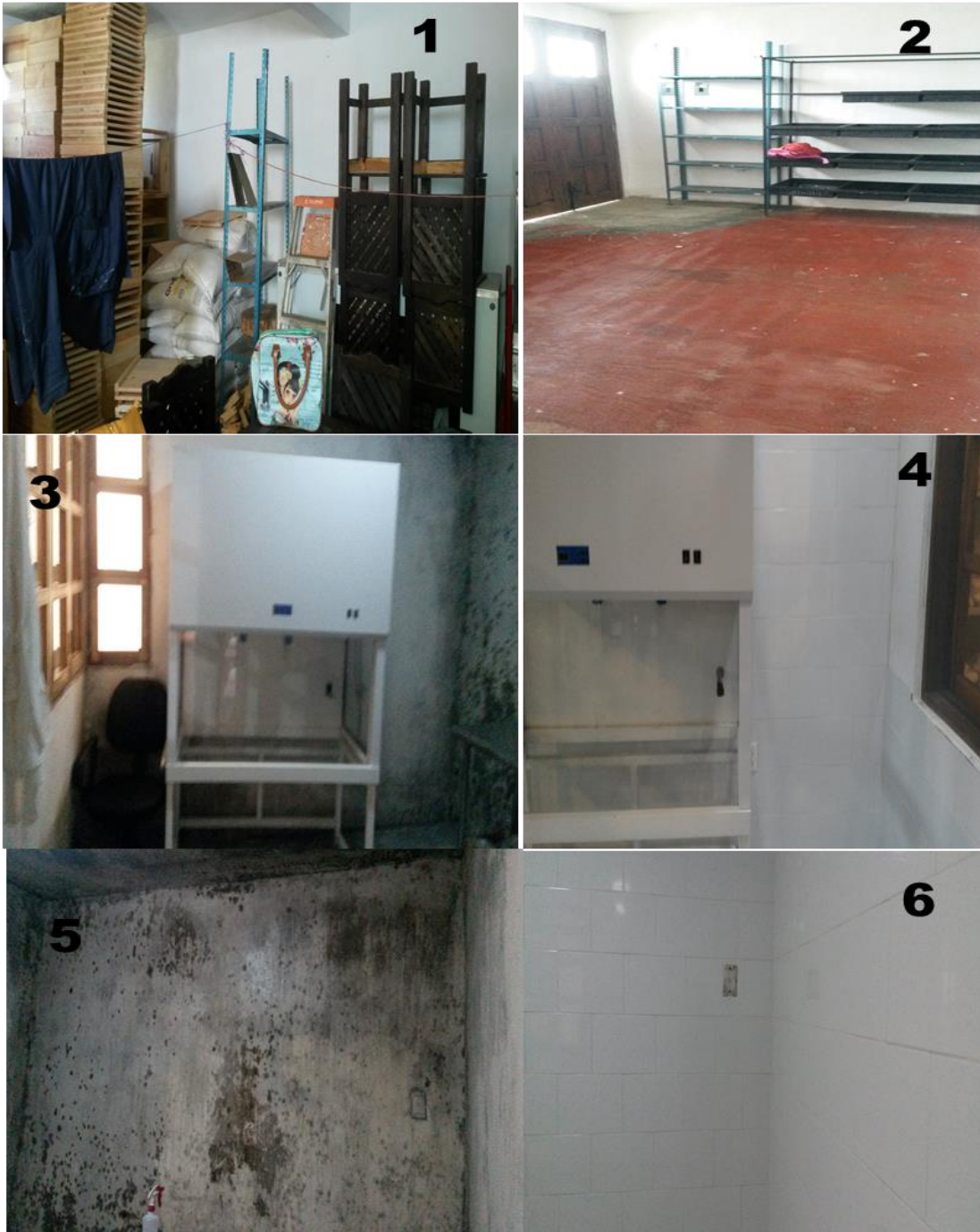
1. Área de acceso al laboratorio, con objetos obstruyendo el paso y almacenando polvo y suciedad. 2. Área de acceso libre de objetos y suciedad. 3. Área de inoculación con seria contaminación en las paredes. 4. Área de inoculación con paredes de azulejo, evitando contaminación y humedad. 5. Área de incubación, con seria contaminación en las paredes. 6. Área de inoculación, paredes cubiertas de azulejo y libre de contaminación.
