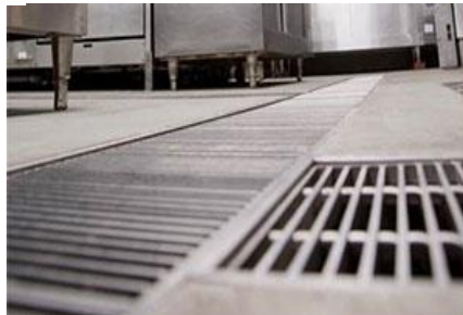
Ilustración 11. Rejillas de drenaje
