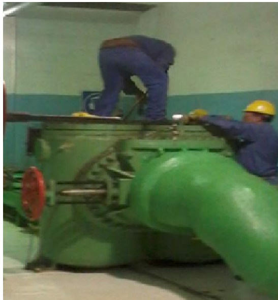
Figura. 1.4 mantenimiento y limpieza de filtros dobles
