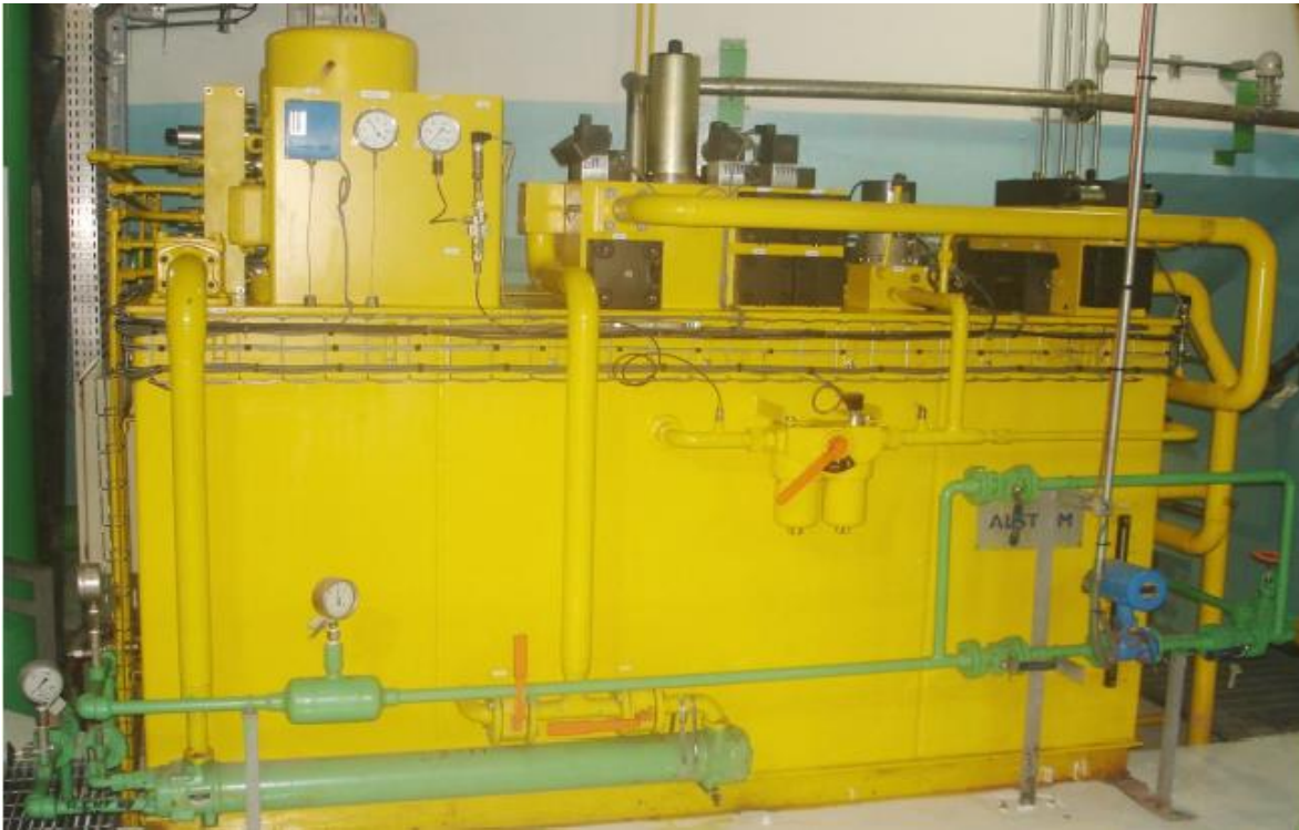
Figura 1.5. Depósito de aceite del Sistema de Regulación de velocidades de la segunda etapa.
