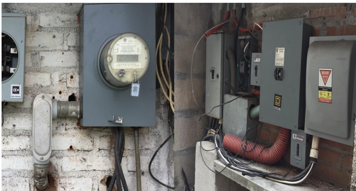
Fig. 3.2 Medidor de energía eléctrica e interruptores
