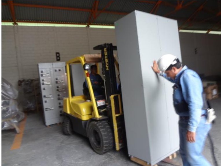
Fig. 7.42 Resguardo del CCM en el almacén de la central.
