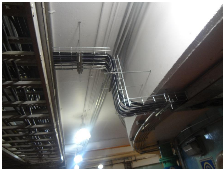
Fig. 7.54 Situación actual del cable con rejilla de protección.
