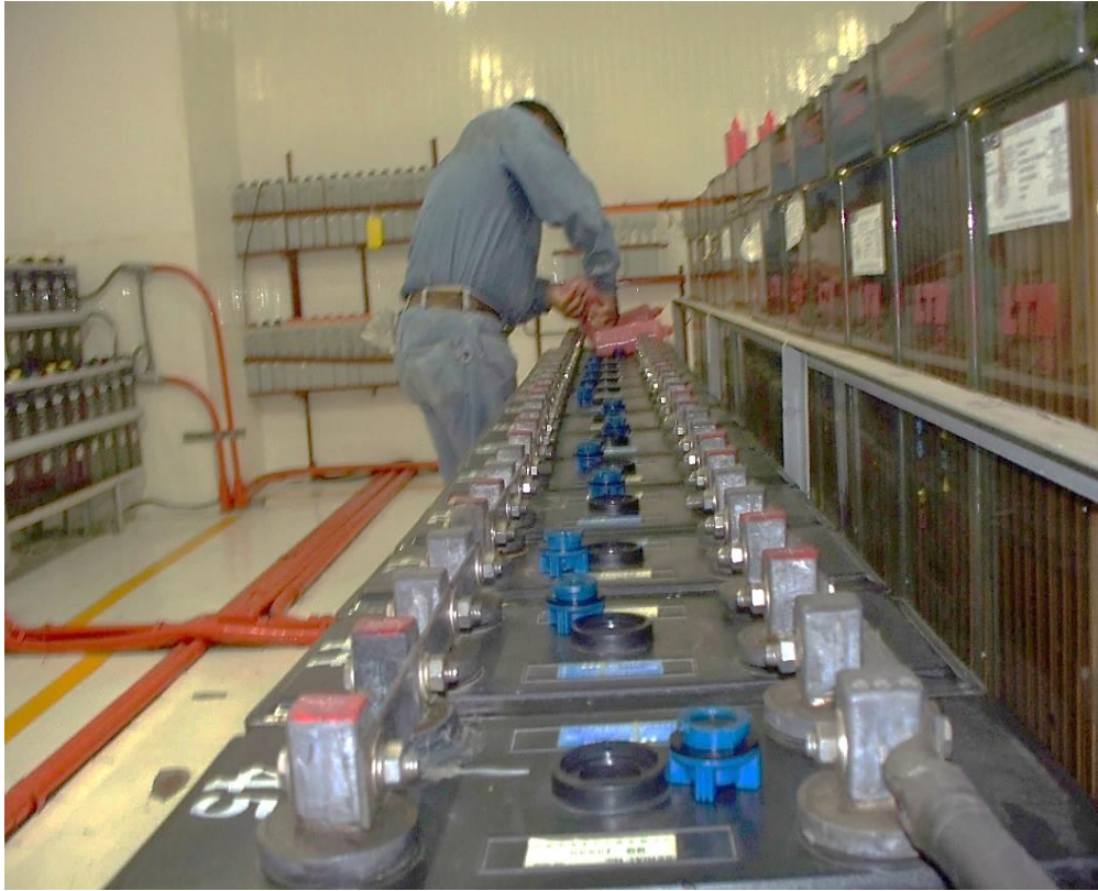
Fig. 7.51 Banco de baterías de la central Hidroeléctrica Malpaso.
