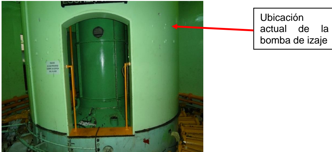
Fig. 7.22 Ubicación de la bomba de izaje.
