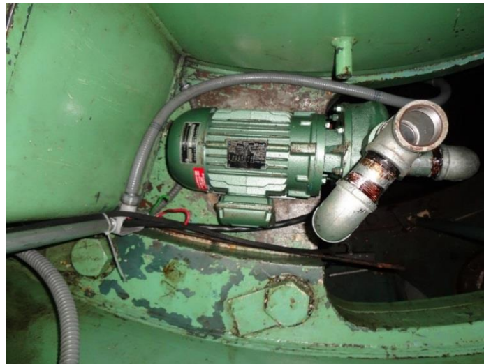
Fig. 7.31 Motor del extractor de fugas del estopero.
