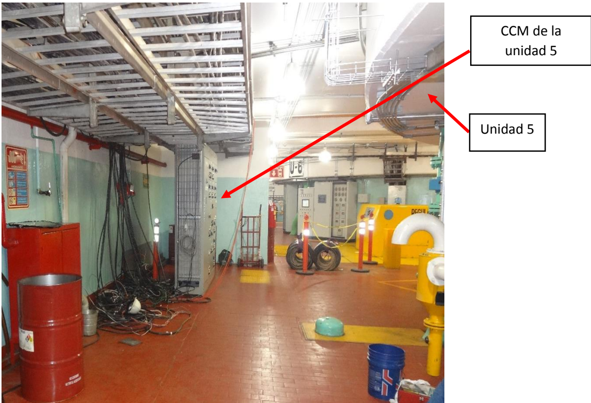
Fig. 7.49 Ubicación actual del CCM en el piso de turbinas.
