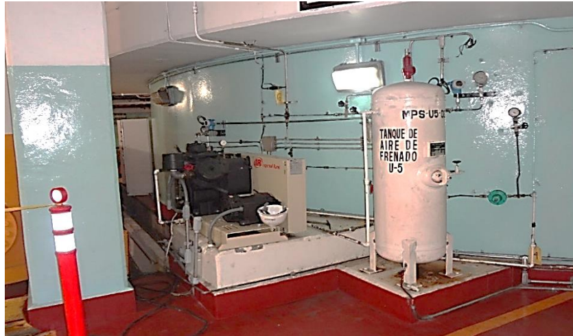
Fig. 7.18 Compresor de Regulación 1.
