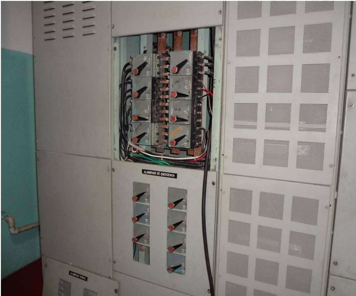
Fig. 7.50 Conexión de la alimentación del tablero de servicios auxiliares al CCM de la U5.
