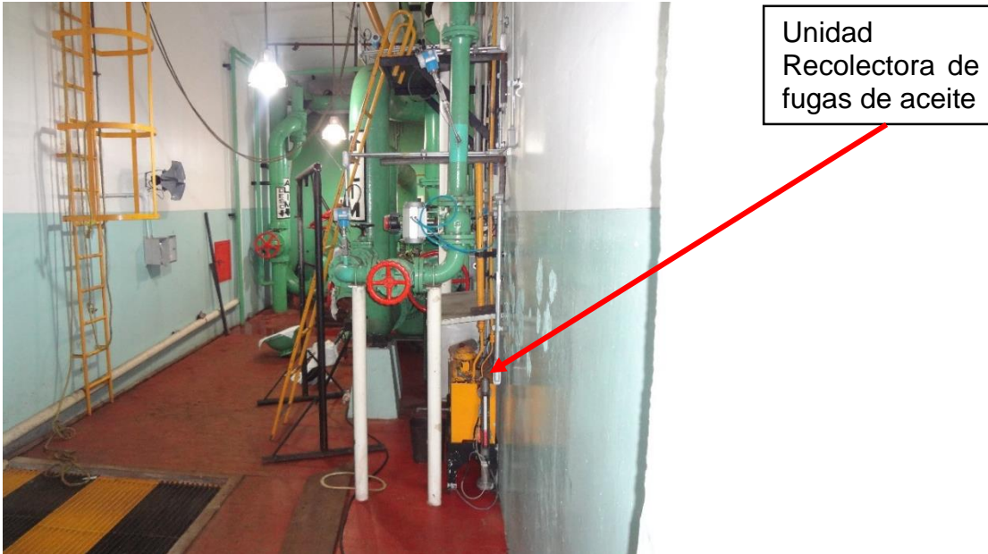
Fig. 7.32 Ubicación actual de la bomba recolectora.
