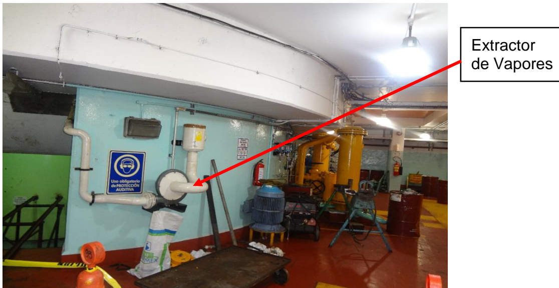
Fig. 7.24 Localización del extractor de Vapores.
