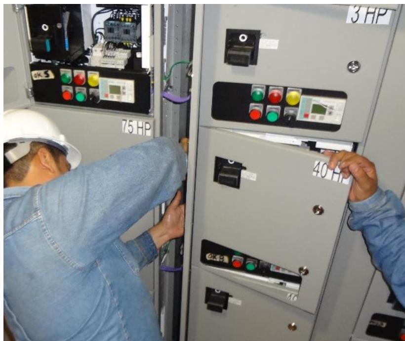
Fig. 7.43 Inspección de gabinetes del CCM
