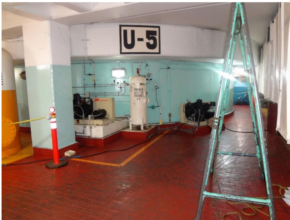
Fig. 7.17 Sitio donde se encuentran los compresores.
