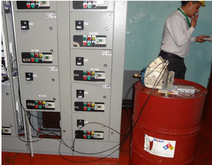
Fig. 7.66 Motor conectado a gabinete para la realización de pruebas.
