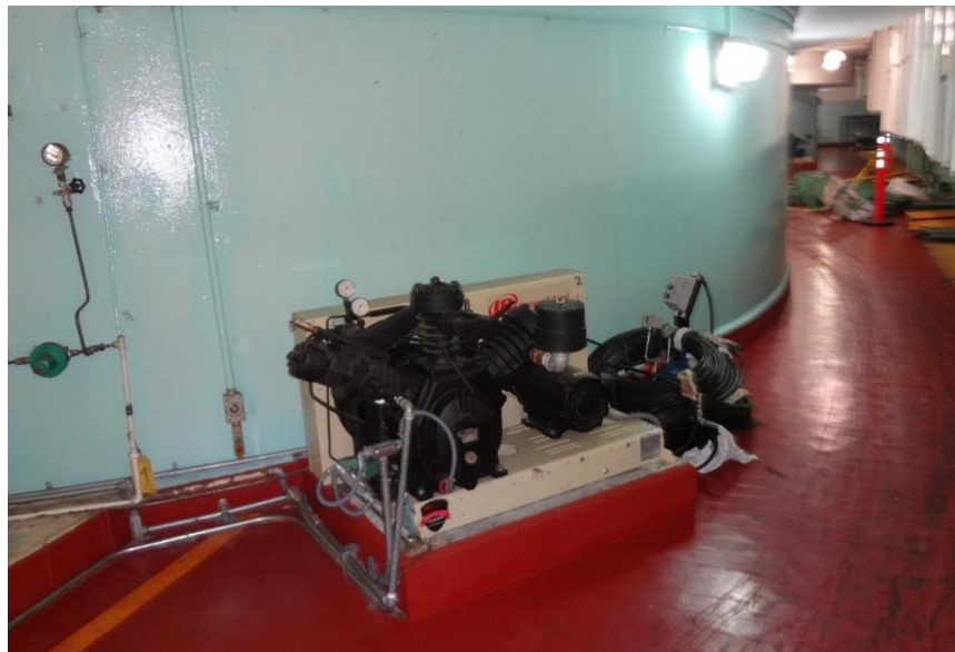
Fig. 7.19 Compresor de Regulación 2.
