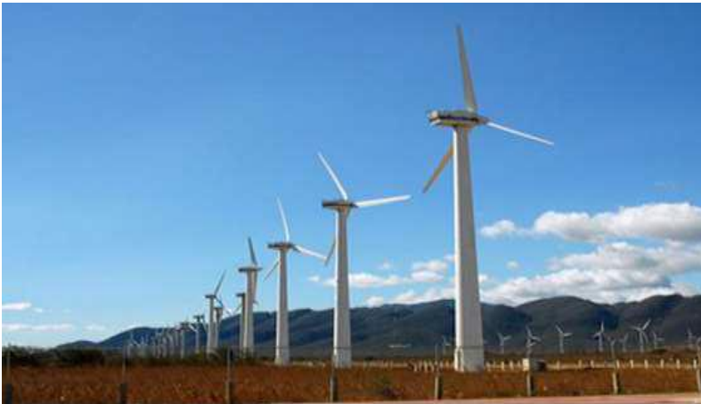
Fig. 3.3 Planta generadora eólica.
