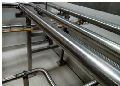
Figura 3.6 canalización el eléctrica para cables de control
