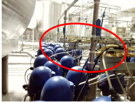
Ilustración 1. 8 Alimentación de aire comprimido
