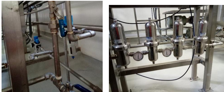
Figura 3.12 Válvula de paso general y filtros de aire comprimido, Sala de jarabes
