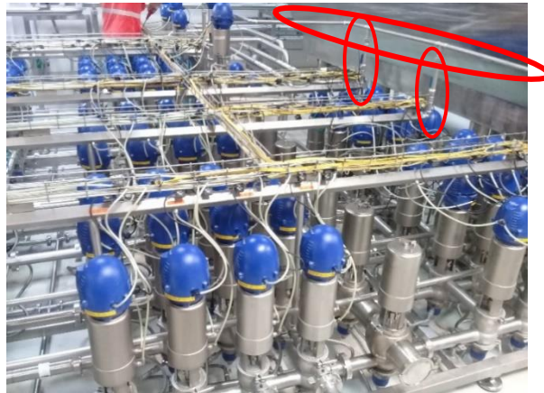
Figura 3.15 Alimentación de aire comprimido y válvulas de paso
