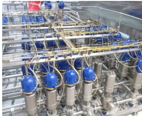
Figura 3.8 cluster de valvulas actual
