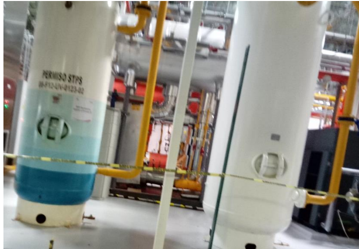
Figura 3.11 tanques de almacenamiento de aire comprimido.
