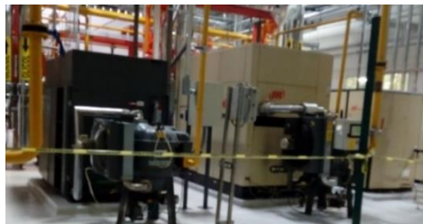
Ilustración 1. 6 Compresores tipo industrial.
