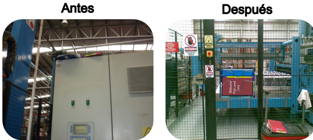
Figura 5.66 Propuesta de mejora para el equipo de la Paletizadora (Fuente: Elaboración propia basada en datos de la Metodología de las 5S)
