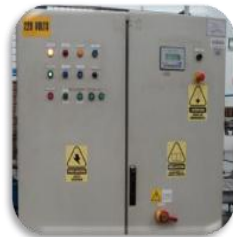
7 Paro de Emergencia
