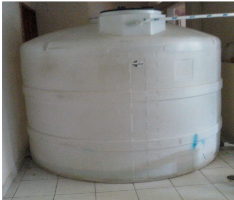
Foto 2-2 Área de almacenamiento del agua
