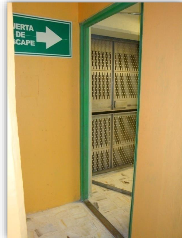
Figura 6.27 Salida de Emergencia Puerta de escape sala de control
