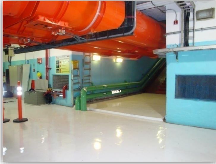
Figura 6.28 Salida de Emergencia de Piso de Barras a Galería de Transformadores
