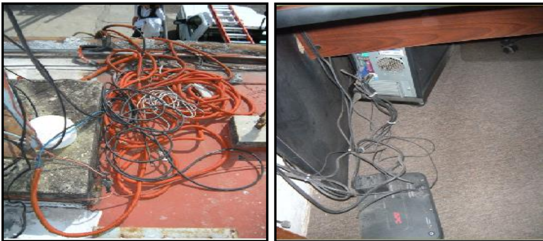
Imagen 4.10 Instalaciones eléctricas provisionales.
