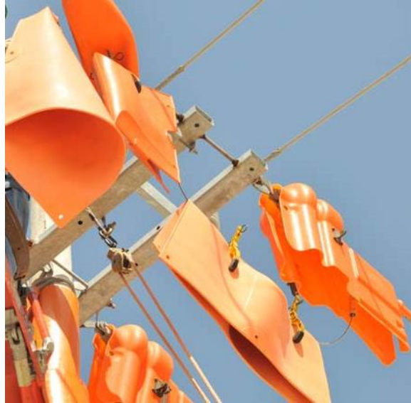
Fotografía N° 11 Mantas y Cubiertas Protectoras aislantes
