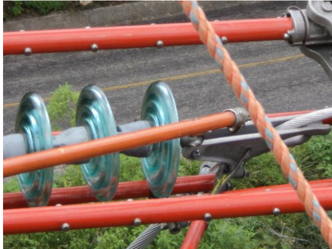
Fotografía N° 46 Cadena de Aisladores Remplazada
