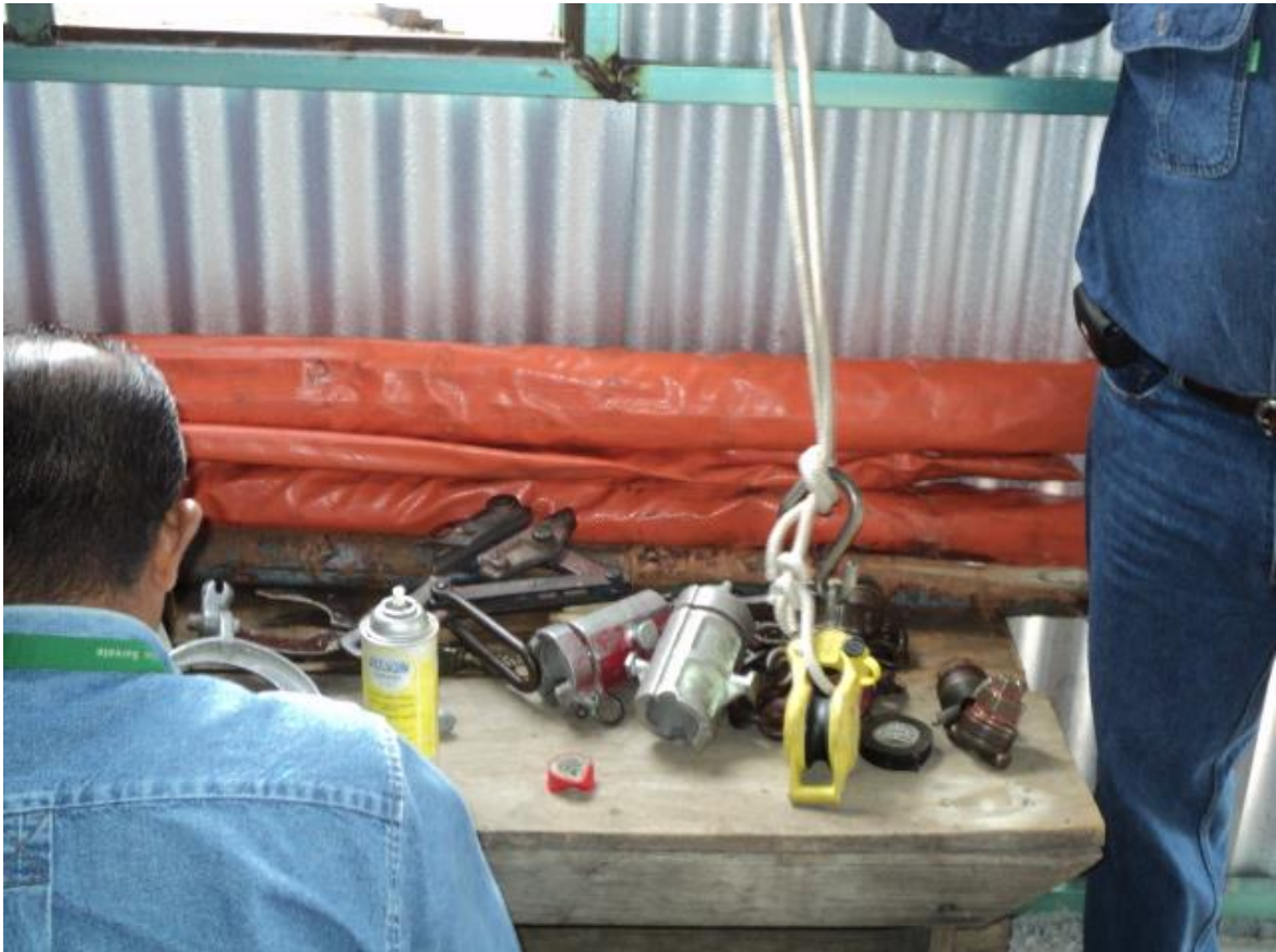
Fotografía N° 22 Equipos Para Líneas Vivas
