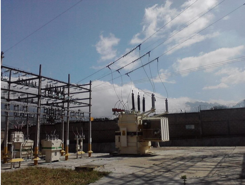
Fotografía N° 18 Subestación Distribución Bochil
