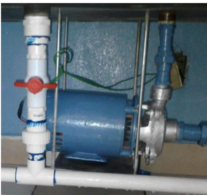
Figura 5.4 Mantenimiento preventivo para equipos.
