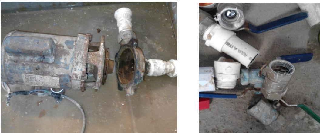
Figura 5.3. Pérdida total del equipo por falta de mantenimiento.
